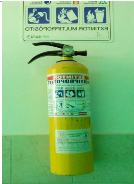
Extintor pasillo Hombres
