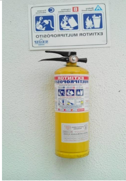
Extintor pasillo Dorado
