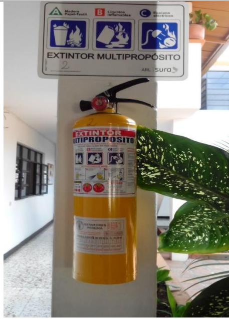
Extintor ubicado en Pasillo principal
