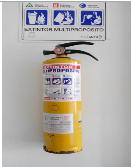
Extintor ubicado en zona de calentadores
