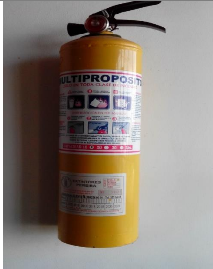
Extintor pasillo zona de Cocina
