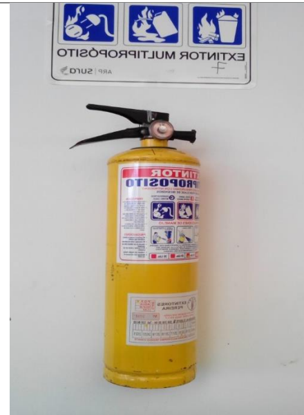
Extintor pasillo Mujeres
