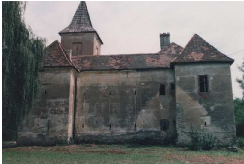
Slika 9. Bočna strana prije restauracije
