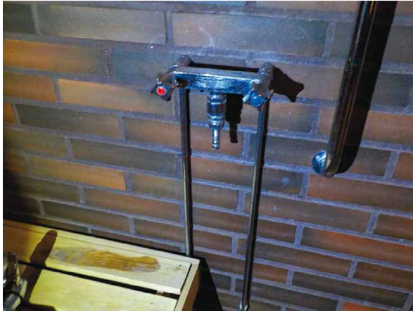
Kuva 3.4. Vanhoista märkätiloista voi puuttua kokonaisuudessaan vedeneristys. (Kuva: P. Annila, Rakennusinsinööri-toimisto Petri Annila)
