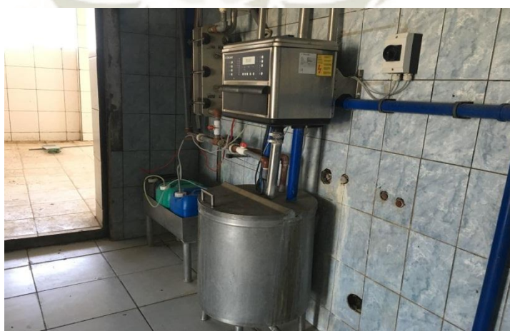
FIGURA 2: EQUIPO COMPLEMENTARIO DE MAQUINA ORDEÑADORA
