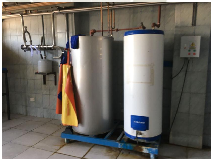
FIGURA 4: TANQUES DE PRESION
