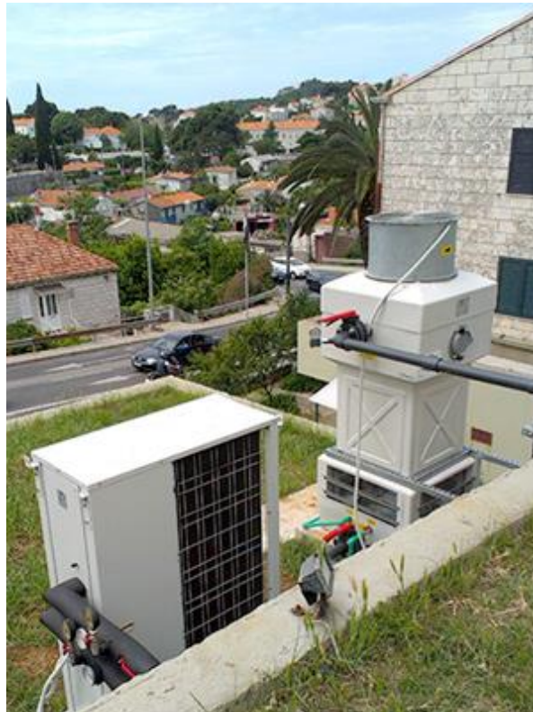
Slika 24. Dizalica topline i mokri rashladni toranj [41]
