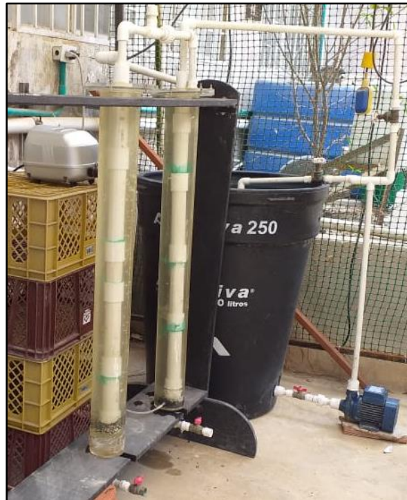
Figura 7. Montaje del sistema de tratamiento con la roca coralina modificada a 400^\circ\text{C} en un reactor tipo Batch con lecho fijo. Adaptado de “Evaluación de materiales bioadsorbentes modificados térmicamente en la remoción de nutrientes presentes en aguas residuales municipales de la ciudad de Barranquilla” por A. L. Díaz y E. P. Rodelo, 2019.
