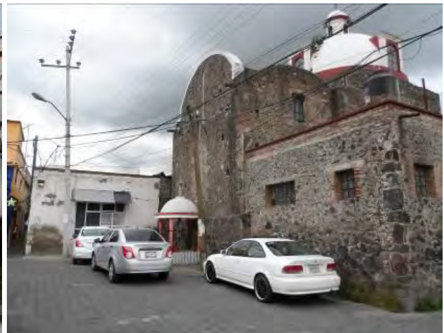
Imagen 213. Fotografía de la fachada oriente de la capilla San Cristóbal, en la cual se muestra la existencia de un tinaco de poliuretano, un altar con elementos de herrería adosada a la fachada, líneas eléctricas aéreas, flora parasita superior en la cúpula y automóviles estacionados a un costado de la capilla, octubre 2015.
