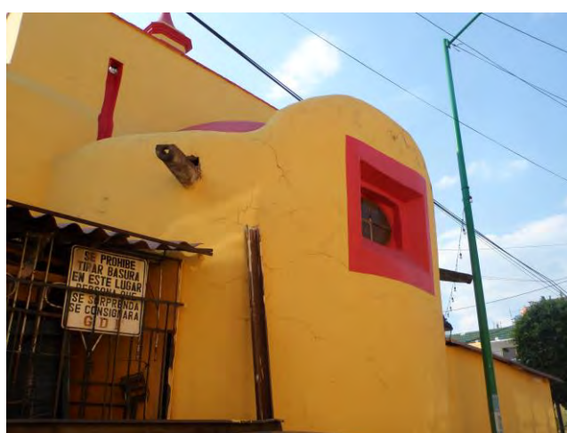
Imagen 285. Fotografía de la fachada Sur-Oriente de la Capilla de San Antonio, se muestran las fisuras que se formaron por el sismo, cabe mencionar que al tener elementos discordantes adosados a la fachada, estos producen deterioros al inmueble, octubre 2017.
