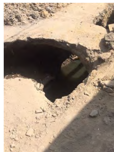
Imagen 274. Fotografía de vialidad del pueblo de Santa Cruz Acalpixca, se muestra la formación de socavón por la ruptura de colector de 0.91 mts de diámetro de aguas negras de asbesto-cemento, delegación Xochimilco, octubre 2017.
