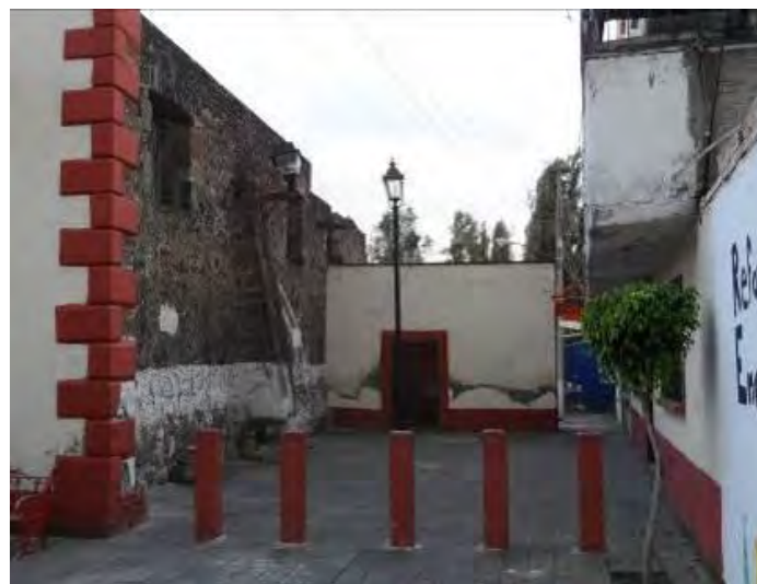
Imagen 229. Fotografía de la fachada sur de la capilla de San Esteban, se muestran elementos metálicos adosados a la misma, presencia de sales en fachada y pintado de rodapié con cal, octubre 2015.
