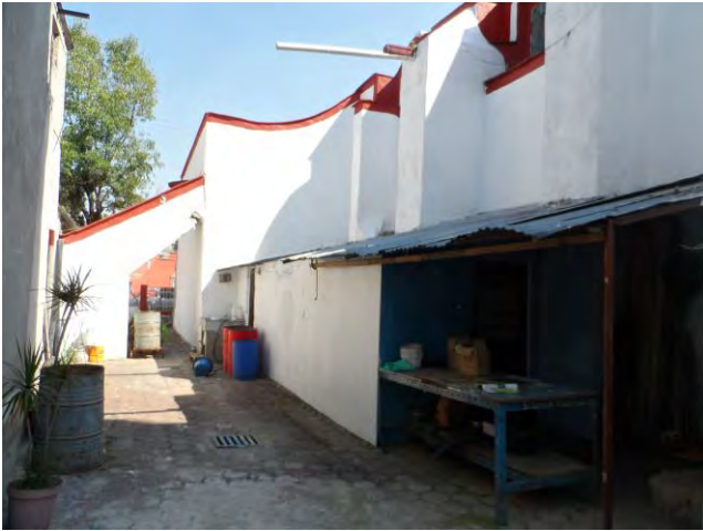
Imagen 289. Fotografía de la fachada Norte de la Capilla de la Asunción, se observa el contrafuerte Norte el cual presenta una grieta a 45°, de igual manera, se observa la existencia de elementos discordantes anexados a la fachada Norte de la capilla, octubre 2017.
