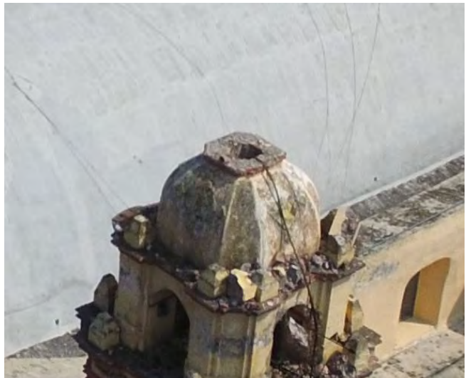
Imagen 312. Fotografía aérea en perspectiva de la torre de campanario del Templo y ex convento de San Bernardino de Siena, se aprecia el lugar que ocupaba la linternilla que colapsó por el sismo, octubre 2017.
