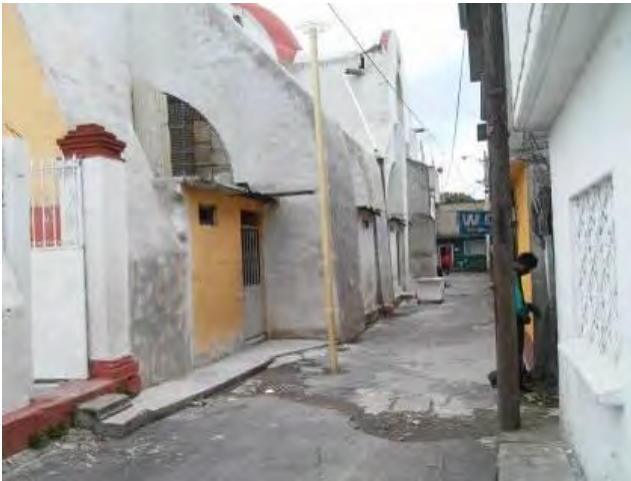
Imagen 263. Fotografía de la fachada poniente de la capilla Xaltocán, se muestra como se apropiaron del espacio entre contrafuertes para construir cuartos los cuales fueron adosados a la capilla, octubre 2015.
