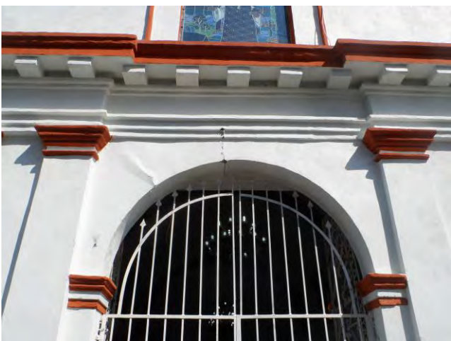
Imagen 295. Fotografía de la fachada de la Capilla de San Esteban, se aprecian dos grietas formadas en la clave del arco de medio punto del acceso principal a la capilla, octubre 2017.
