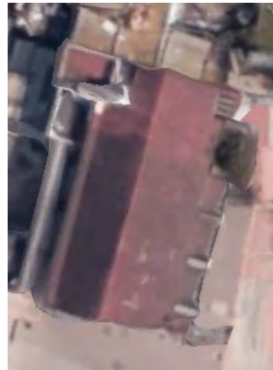
Imagen 79. Imagen aérea de la Cubierta de la Capilla de San Diego, marzo 2014. Fuente: www.googlemaps.
