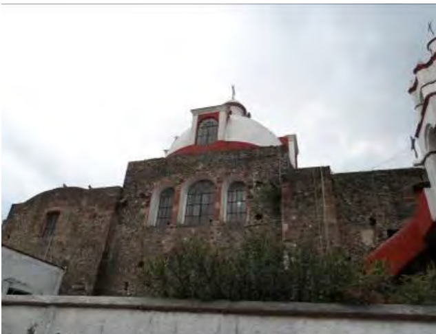
Imagen 212. Fotografía de la fachada norte de la capilla de San Cristóbal, se muestra la existencia de flora parasita superior en el contrafuerte norte, así como huecos provocados por la pérdida del material, octubre 2015.
