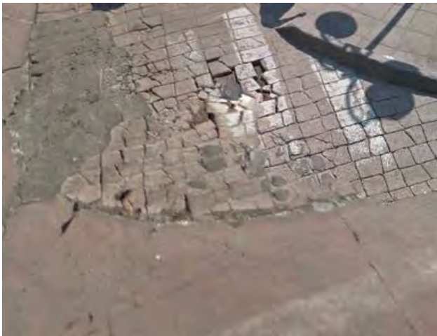
Imagen 179. Fotografía en la cual se muestra la falta de homogeneidad en los acabados de la calle Chilalpa, así como el mal estado de conservación de los mismos, centro Histórico de Xochimilco, octubre 2015.
