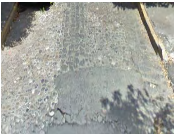
Imagen 181. Fotografía en la cual se muestra el bacheo que se ha realizado con material diferente al existente en la vialidad de la calle Las Rosas entre la Av. México y cerrada Rosas, centro Histórico de Xochimilco, octubre 2015.
