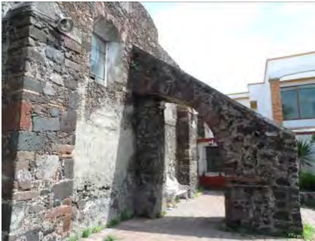
Imagen 219. Fotografía de muro de la fachada sur de la capilla Santa Crucita, se muestra la colocación de aplanado de cemento-arena en muro en lugar de realizar remamposteo octubre 2015.
