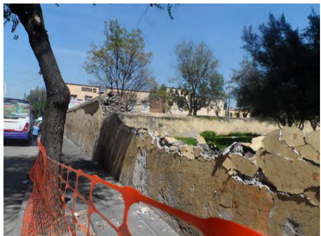
Imagen 314. Fotografía de la barda atrial poniente del Templo y ex convento de San Bernardino de Siena, se aprecia el espesor que tiene la barda, la cual es de 1.20 mts., octubre 2017.
