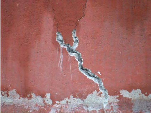
Imagen 315. Fotografía de la barda atrial norte del Templo y ex convento de San Bernardino de Siena, la cual en el año 2005 presentaba varias fisuras en toda su longitud, cuando se descubrió el aplanado para poder evaluar el daño, se encontró que la fisura era una grieta de un espesor y profundidad considerable, agosto 2005.
