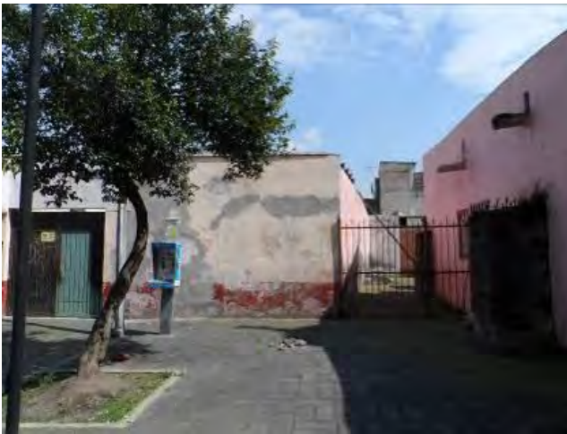
Imagen 234. Fotografía de la fachada norte de la capilla de San Juan, se muestra la colocación de estructura metálica adosada a la fachada para apropiarse del espacio, así como elementos metálicos colocados en la parte superior de contrafuerte, octubre 2015.
