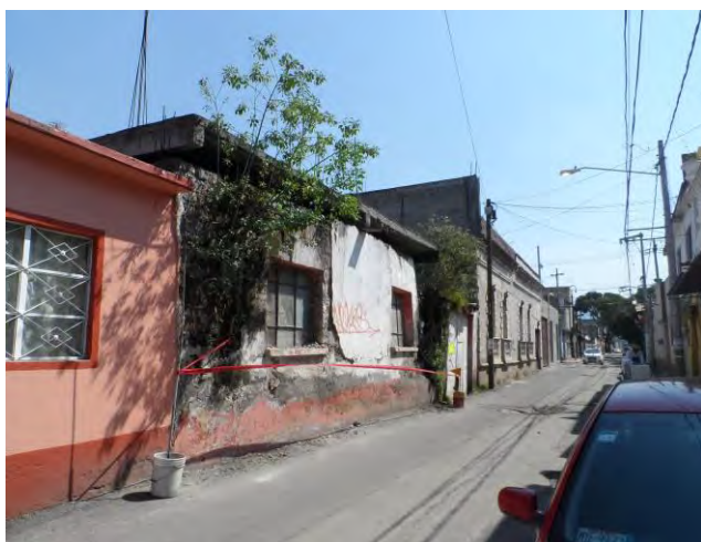
Imagen 275. Fotografía en la cual se muestra el daño que presenta Inmueble ubicado en la calle Benito Juárez a consecuencia del sismo del 19 de septiembre y por la falta de mantenimiento, Barrio Concepción Tlacoapa, en octubre 2017.
