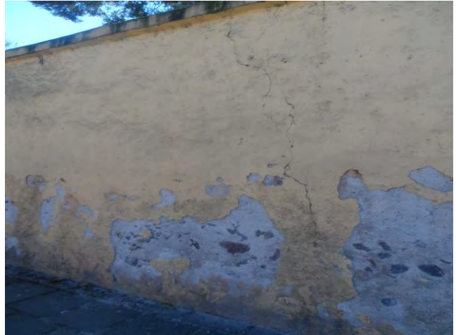
Imagen 316. Fotografía de la barda atrial norte del Templo y ex convento de San Bernardino de Siena, se muestran las fisuras que se formaron a todo lo largo de la barda atrial que no colapso en el sismo del 19 de septiembre, las fisuras existentes son similares a las que se presentaron en el año 2005, por lo que es necesario descubrir el aplanado para analizar y restaurar la barda atrial, octubre 2017.
