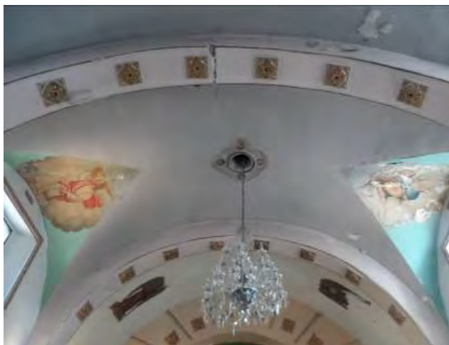
Imagen 216. Fotografía de la bóveda en el interior de la capilla Santa Crucita, se muestra el deterioro que presenta la pintura mural por la presencia de humedad, octubre 2015.
