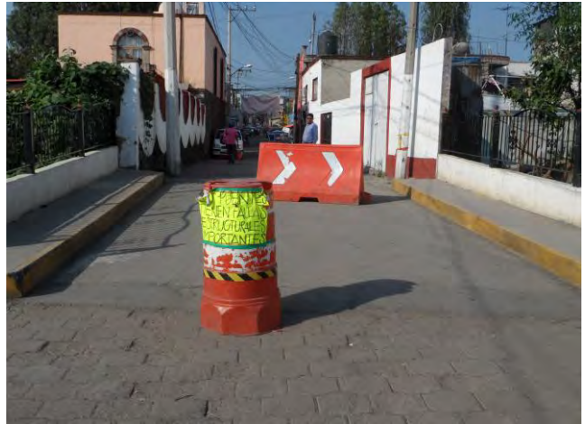
Imagen 278. Fotografía del puente del canal Achicalco a la altura del barrio Caltongo, el cual presenta una grieta, por lo que está cerrando al tránsito vehicular desde el 19 de septiembre, octubre 2017.
