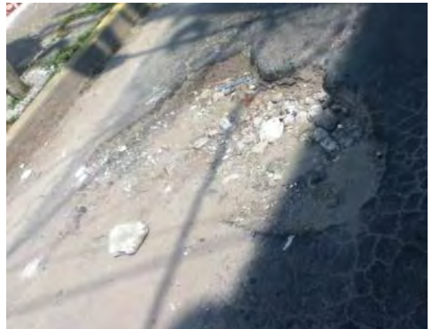
Imagen 180. Fotografía en la cual se muestra el mal estado de la vialidad, debido a la existencia de baches en la Av. 5 de mayo entre las calles Francisco I. Madero y Av. Nuevo León, centro Histórico de Xochimilco, octubre 2015.
