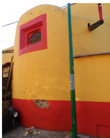
Imagen 284. Fotografía de la fachada Nor-Oriente de la Capilla de San Antonio, se muestran las fisuras que se formaron a consecuencia del sismo del 19 de septiembre, así como la pérdida de aplanado en una pequeña sección de la misma, octubre 2017.
