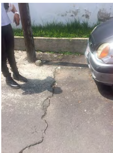
Imagen 273. Fotografía de calle del pueblo de Santa Cruz Acalpixca, se muestra una grieta formada en vialidad a consecuencia del sismo del 19 de septiembre, delegación Xochimilco, octubre 2017.
