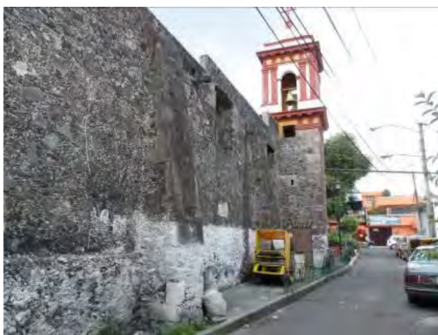
Imagen 226. Fotografía de la fachada norte de la capilla de San Esteban, se muestra estructura metálica incrustada en el contrafuerte norte, la apropiación del espacio de la capilla para colocar costales de cascajo y bicitaxis, aplicación de pintura a la cal en rodapié y la existencia de flora parasita inferior en contrafuertes, octubre 2015.
