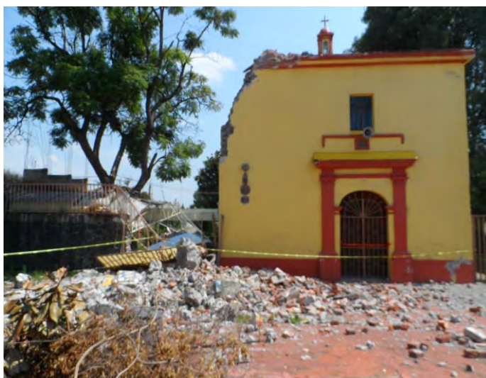
Imagen 300. Fotografía de la fachada principal de la Capilla de San Marcos, se aprecian los escombros de la torre de campanario y el daño que sufrió la capilla a consecuencia del sismo, octubre 2017.
