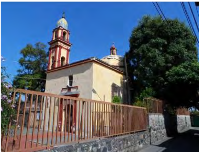
Imagen 244. Fotografía de la fachada principal de la capilla de San Marcos, se muestra la colocación de lámina de aluminio sobre chafalán de concreto en la parte superior de la portada, bocina adosada en la fachada así como el craquelamiento que presenta la pintura a la cal, octubre 2015.
