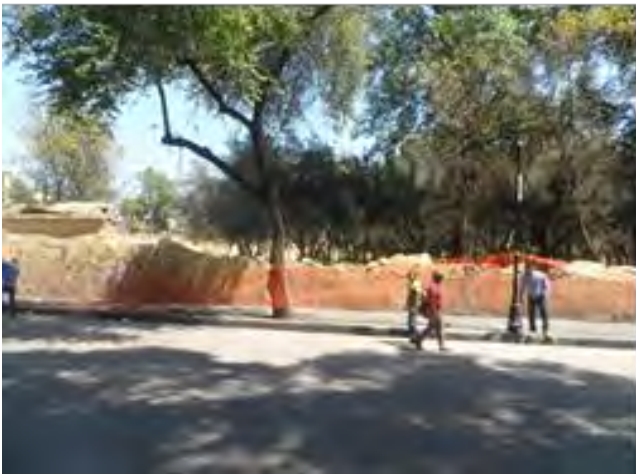
Imagen 313. Fotografía de la barda atrial poniente del Templo y ex convento de San Bernardino de Siena, se muestra la parte de la barda atrial que colapso por el sismo, octubre 2017.
