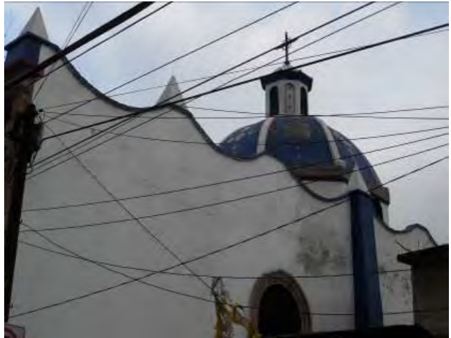
Imagen 241. Fotografía de la fachada sur de la capilla de San Lorenzo, en la cual se muestra el craquelado y desprendimiento de la pintura por el intemperismo, octubre 2015.
