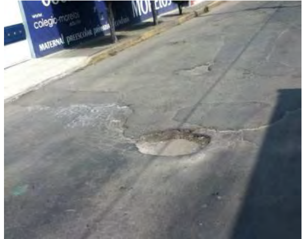
Imagen 178. Fotografía en el cual se muestra el mal estado de la vialidad debido a la existencia de baches, en la Av. 5 de mayo entre Nezahualcóyotl y Francisco I. Madero, centro Histórico de Xochimilco, octubre 2015.
