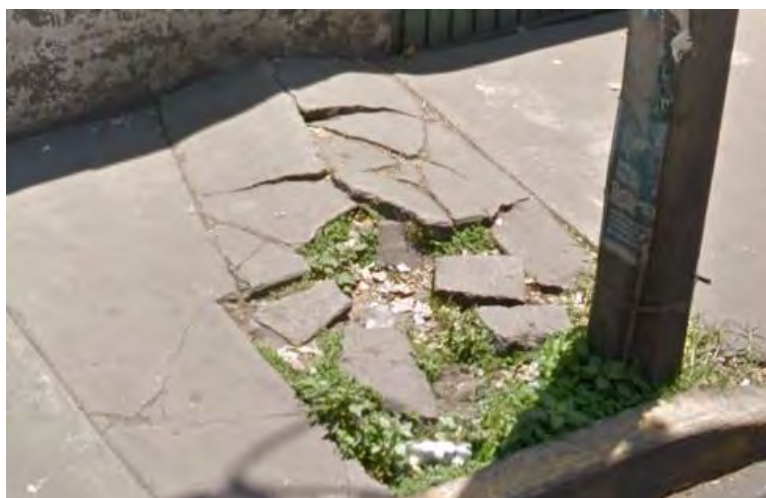
Imagen 176. Fotografía del mal estado de conservación de la banqueta, ubicado en la Av. Nuevo León casi esquina con calle de la Rosa, centro Histórico de Xochimilco, octubre 2015.
