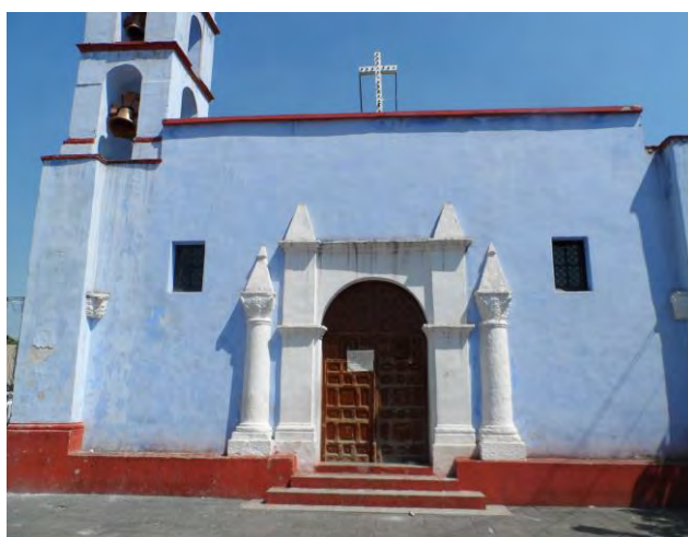
Imagen 291. Fotografía de la fachada de la Capilla de Belem, donde se observa que recientemente a la torre de campanario se le colocó un aplanado y aplicó pintura a la cal de color azul igual al de la fachada, octubre 2017.
