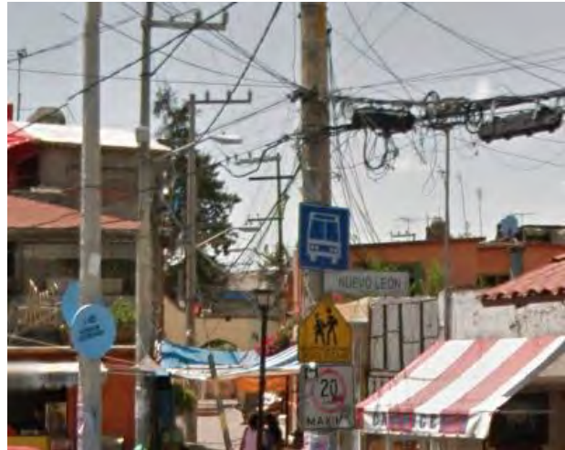
Imagen 187. Fotografía en la cual se muestra la mala imagen urbana que es causada por el exceso de cableado aéreo que convergen en los postes de concreto ubicados en la Av. Nuevo León esquina con calle de la Rosa, centro Histórico de Xochimilco, octubre 2015.
