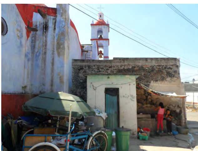
Imagen 292. Fotografía de la fachada Norte de la Capilla de Belem, se puede observar cómo la gente que vive en la parte posterior de la capilla construyó un cuarto adosado a la misma, octubre 2017.
