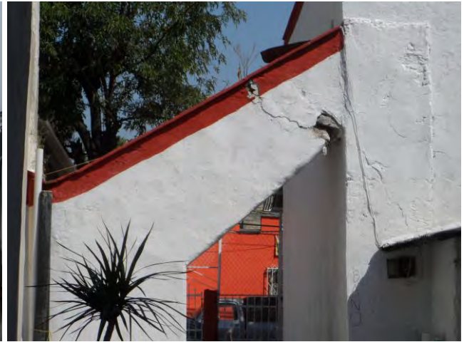
Imagen 290. Fotografía de la grieta formada en el contrafuerte Norte de la capilla de la Capilla de la Asunción, donde el contrafuerte deberá apuntalarse con polines de madera para evitar que la grieta pueda crecer de tamaño, octubre 2017.
