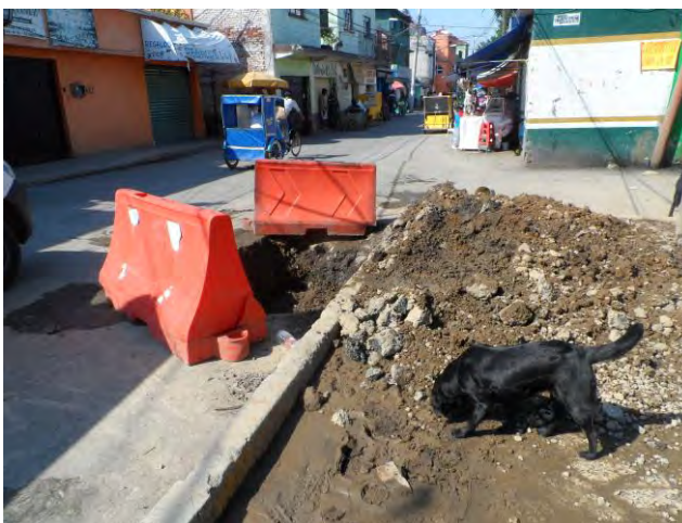
Imagen 296. Fotografía de la calle Dalia frente a la capilla de San Esteban, en la cual se observa socavón producido por la ruptura de una tubería de agua potable propiedad del SACMEX, octubre 2017.
