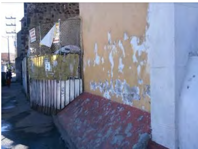
Imagen 260. Fotografía de la fachada oriente de la capilla Xaltocán, se muestra el deterioro que presenta parte del muro así como parte de una estructura metálica que adosaron a la fachada, octubre 2015.
