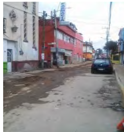
Imagen 182. Fotografía en la cual se muestra el mal estado de la calle Dalia entre las calles Josefa Ortiz de Domínguez y Adelaida, centro de Xochimilco, octubre 2015.
