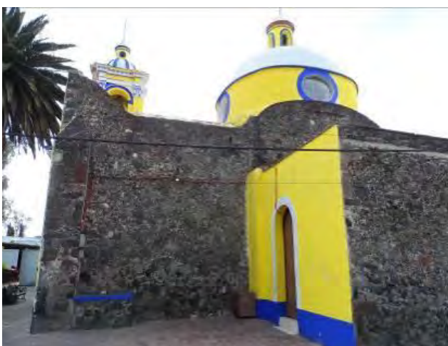
Imagen 257. Fotografía de la fachada sur de la capilla de la Santísima, se muestra la existencia de canalización eléctrica adosada a la fachada, octubre 2015.
