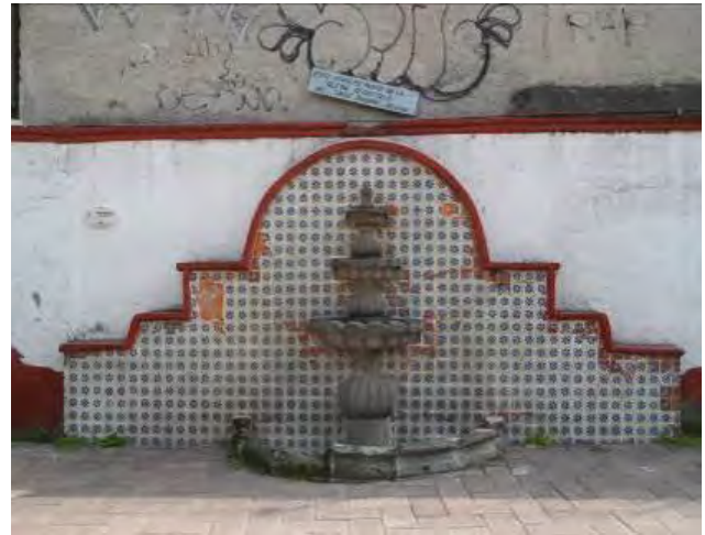
Imagen 220. Fotografía de fuente de cantera, la cual presenta deterioro por la pérdida de piezas de cantera que la componen y por el abandono en el que se encuentra, plaza de la capilla Santa Crucita, octubre 2015.
