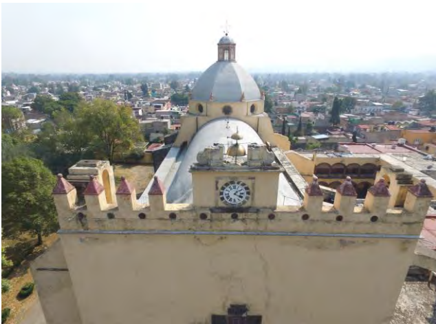
Imagen 307. Fotografía aérea del Templo y ex convento de San Bernardino de Siena, se aprecian los restos de la Espadaña que no colapsaron, las grietas que se formaron en la fachada principal, y la bóveda de cañón corrido, tambor de cúpula, cúpula y linternilla que no tienen afectación, octubre 2017.
