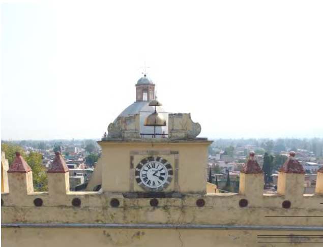
Imagen 328. Fotografía del reloj que se ubica sobre la fachada principal del Templo y ex convento de San Bernardino de Siena, se puede apreciar que el área de la Espadaña que contaba con elementos de fijación no colapsó en el sismo del 19 de septiembre, octubre 2017.
