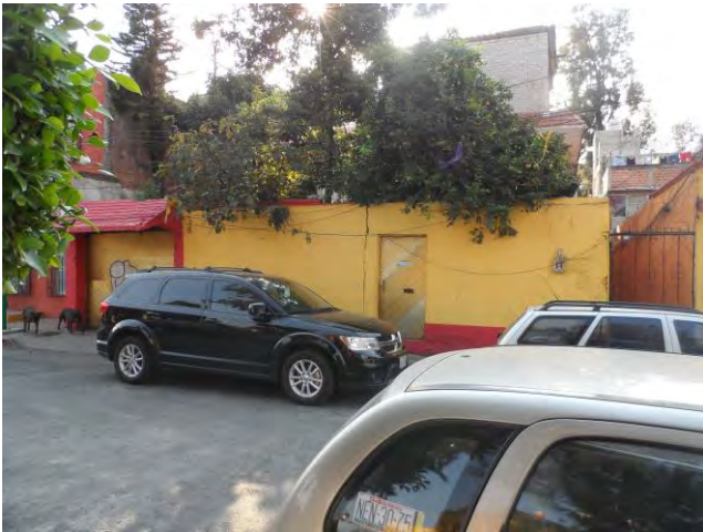
Imagen 279. Fotografía en el cual se muestra el daño que presenta la barda de una casa a consecuencia del sismo del 19 de septiembre, ubicada frente a la capilla de San Antonio, octubre 2017.
