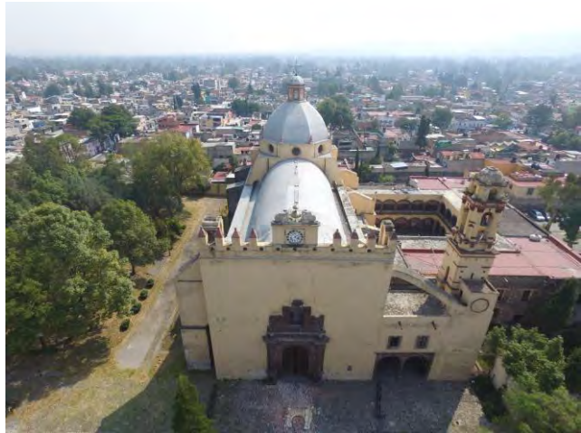
Imagen 308. Fotografía aérea del Templo y ex convento de San Bernardino de Siena, en la cual se aprecia la pérdida de la linternilla y de la cruz metálica que estaban en la parte superior de la torre del campanario, asimismo, se pueden observar el conjunto de las afectaciones que sufrió el templo, octubre 2017.
