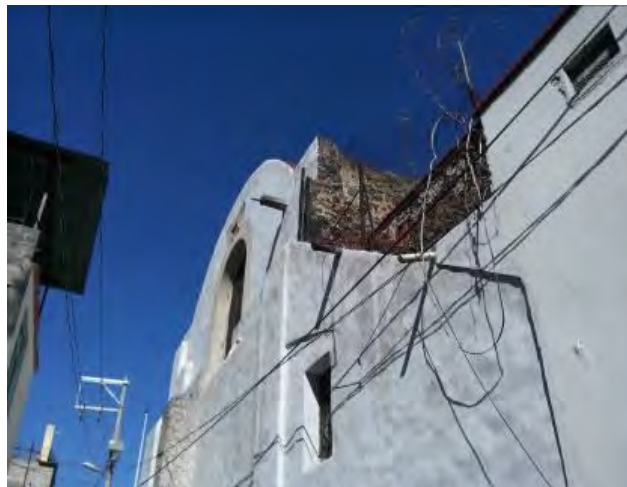
Imagen 265. Fotografía de la fachada poniente de la capilla Xaltocán, se muestra la existencia de flora parasita superior y tubo de PVC para el desagüe de agua en lugar de pérgolas de cantera, octubre 2015.
