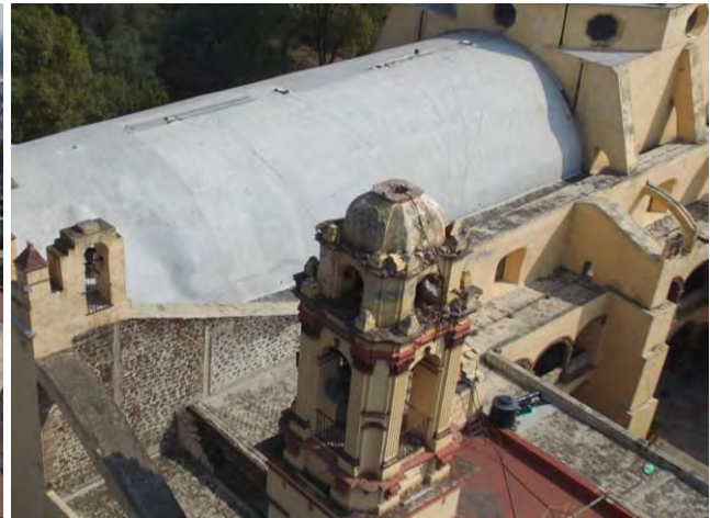
Imagen 310. Fotografía aérea en perspectiva de la torre de campanario del Templo y ex convento de San Bernardino de Siena, en la cual se aprecia como en el tercer cuerpo de la torre, existen restos de la linternilla que colapsó, es urgente que el material que se encuentra en el interior de la torre sea retirado porque puede producir un accidente si llegase a caerle a alguna persona, octubre 2017.
