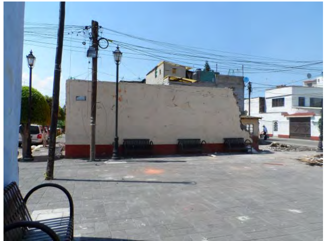
Imagen 280. Fotografía de Inmueble colapsado a consecuencia del sismo del 19 de septiembre, ubicado frente a la capilla de Belem, octubre 2017.
