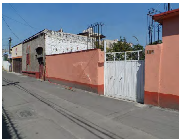
Imagen 276. Fotografía en el que se muestra la afectación que sufrió la barda de un inmueble a consecuencia del sismo del 19 de septiembre, el cual se ubica en la calle Benito Juárez, Barrio Concepción Tlacoapa, octubre 2017.
