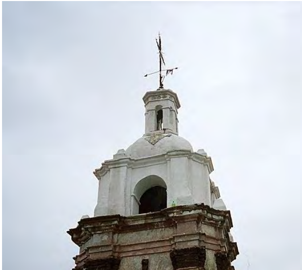
Imagen 311. Fotografía de la aplicación de enlucido de cal apagada en linternilla de la torre de campanario del Templo y ex convento de San Bernardino de Siena, se aprecia la linternilla y la cruz metálica, agosto 2005.
