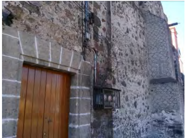
Imagen 264. Fotografía de la fachada oriente de la capilla Xaltocán, se muestra el tendido de canalización eléctrica adosada a la fachada y construcción de contrafuerte de concreto, octubre 2015.
