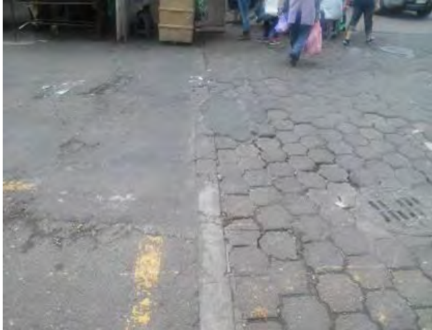
Imagen 177. Fotografía en el cual se muestra la falta de homogeneidad en los acabados de las calles de la calle Francisco I. Madero esquina con Av. José Ma. Morelos, centro Histórico de Xochimilco, octubre 2015.
