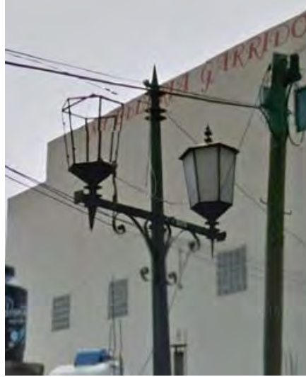
Imagen 153. Fotografía del estado en el que se encuentran varias de las luminarias en la zona de barrios, octubre 2015.
