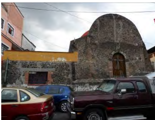
Imagen 227. Fotografía de la fachada oriente de la capilla de San Esteban, en la cual se muestra la apropiación del espacio posterior de la capilla el cual utilizan de estacionamiento, colocación de elementos discordantes a la fábrica original (trabe de concreto armado, colocación de tabique rojo en perímetro de ventana y colocación de tubo metálico para bajada de agua pluvial), octubre 2015.
