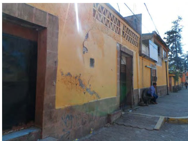
Imagen 298. Fotografía de la fachada de una casa que se ubica a un costado de la Capilla de San Francisco, en la cual se aprecian grietas en los muros a consecuencia del sismo de 19 de septiembre, octubre 2017.
