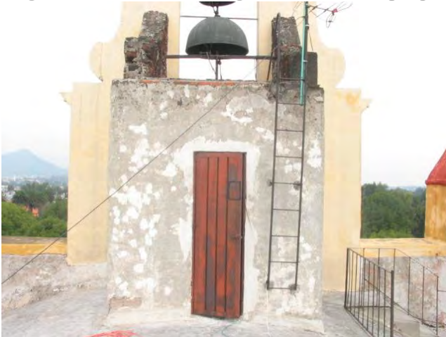
Imagen 326. Fotografía del cuarto de máquina del reloj que se ubica sobre la fachada principal del Templo y ex convento de San Bernardino de Siena, se pueden apreciar los elementos de fijación con los que contaba la Espadaña, septiembre 2006.
