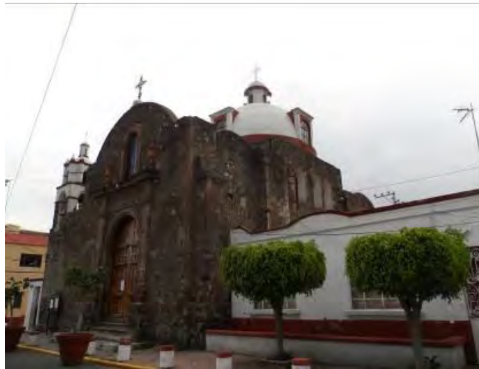
Imagen 215. Fotografía de portón de madera de la fachada principal de la capilla San Cristóbal, en la cual se observa el deterioro que presenta debido al intemperismo, octubre 2015.
