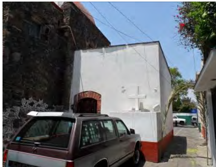
Imagen 211. Fotografía de la fachada norte de la capilla de La Concepción, se muestra una mala intervención realizada a la capilla (remamposteo con cemento), octubre 2015.
