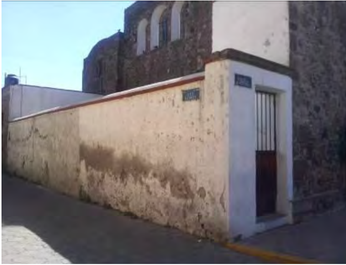
Imagen 214. Fotografía de la fachada norte de la capilla San Cristóbal, en la cual se muestra un muro adosado a la fachada, mismo que se construyó de manera irregular y provoca esfuerzos discordantes a la misma, octubre 2015.
