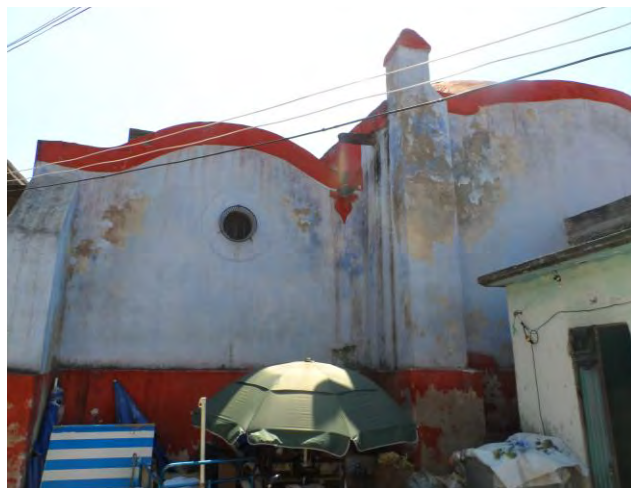
Imagen 205. Fotografía de la fachada Norte de la capilla de Belem, en la cual se muestra la construcción de un baño adosado a la capilla y el mal estado de conservación de la pintura en esa zona, octubre 2015.
