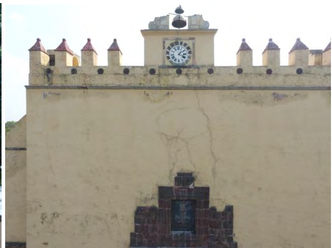
Imagen 306. Fotografía de la parte superior de la fachada principal del Templo y ex convento de San Bernardino de Siena, se aprecian grietas que se formaron a consecuencia del sismo, la grieta del lado derecho inicia en el reloj, baja por la fachada y llega a la arista de la parte superior derecha de la portada principal, la grieta del lado izquierdo se forma en lo que es el óculo y pasa por una junta de los sillares de la portada principal, de igual manera, se observan los restos de la Espadaña que colapso en el sismo octubre 2017.
