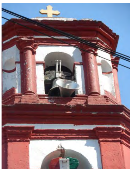
Imagen 287. Fotografía en la cual se observa la grieta formada en el vano del arco de medio punto del primer cuerpo de la torre de campanario de la capilla de la Asunción, octubre 2017.
