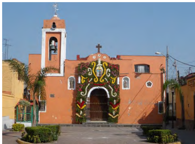
Imagen 297. Fotografía de la fachada principal de la Capilla de San Francisco, no se aprecia ningún daño a consecuencia del sismo de 19 de septiembre, octubre 2017.
