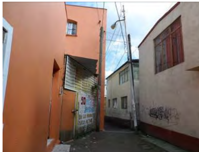
Imagen 233. Fotografía de la fachada sur de la capilla de San Francisco Caltongo, en la cual se muestra la colocación de elementos adosados a la fachada, así como la colocación de instalación y cableado eléctrico en postes de concretos ubicados a un costado de la capilla, octubre 2015.
