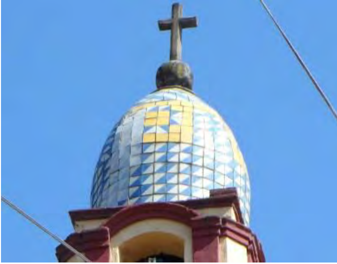
Imagen 246. Fotografía del cupulín de la torre de campanario de la capilla de San Marcos, se muestra la colocación de piezas de talavera diferentes a la de la fábrica original, octubre 2015.
