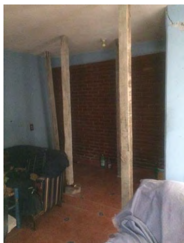
Imagen 272. Fotografía de Inmueble ubicado en el pueblo de Santa Cruz Acalpixca, se muestra el apuntalamiento que se realizó al interior del inmueble como medida de seguridad por grietas formadas en losa a consecuencia del sismo del 19 de septiembre, delegación Xochimilco, octubre 2017.
