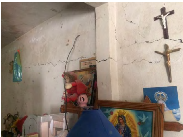
Imagen 270. Fotografía de Inmueble ubicado en el pueblo de Santa Cruz Acalpixca, se muestran las grietas formadas en muros y castillos a consecuencia del sismo del 19 de septiembre, delegación Xochimilco, octubre 2017.
