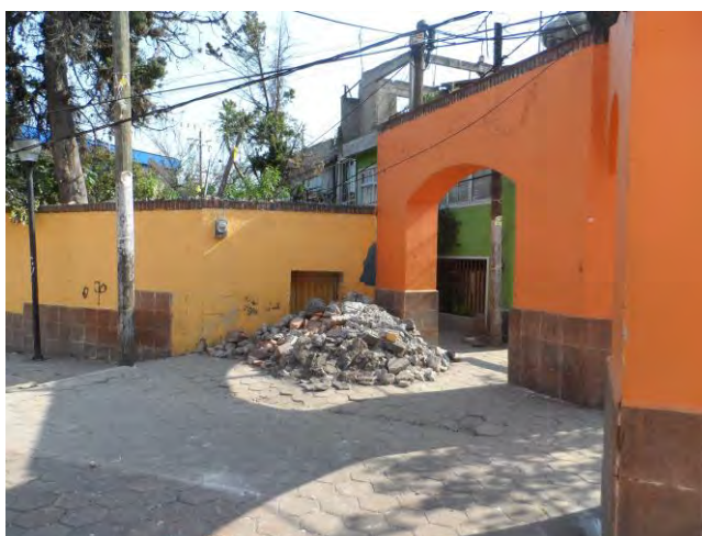
Imagen 299. Fotografía de la plaza de la Capilla de San Francisco, se observan daños en el piso de la misma, así como el escombros de una barda que colapso a consecuencia del sismo de 19 de septiembre, octubre 2017.
