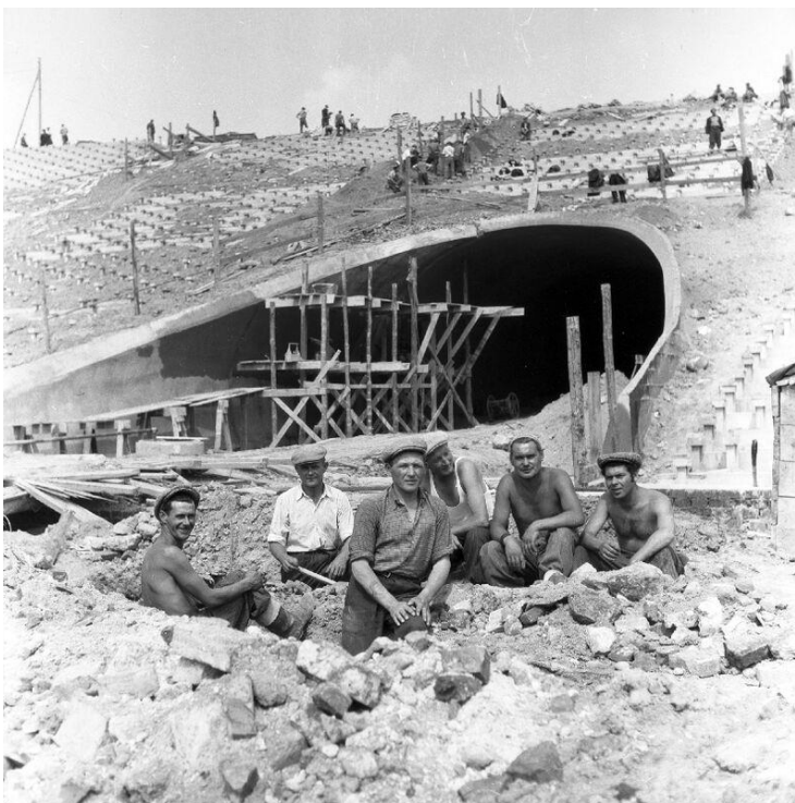
FAF/A. Dłubak, Archiwum Zbigniewa Dłubaka, Ostatnia faza budowy Stadionu X-lecia w Warszawie – grupa robotników, negatyw na błonie fotograficznej, 1955, sygn. 01-N-02-00007
