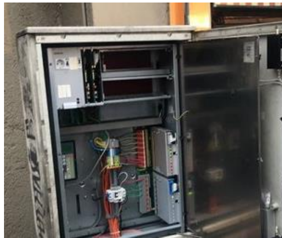
Ilustración 8 Rack de Comunicación en una central de control
