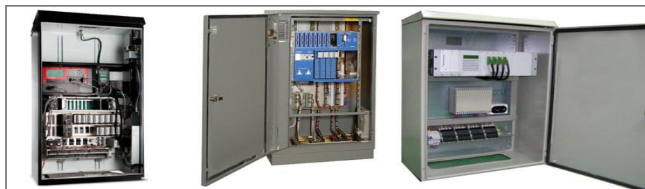
Ilustración 5 Equipo de Control local.
