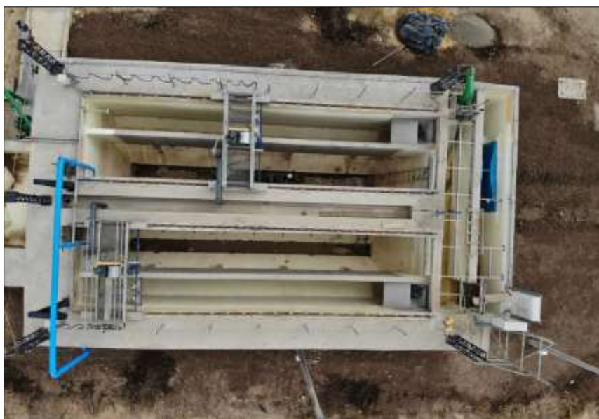
Ilustración 22. Desarenador-Desengrasado y Canaleta Parshall
