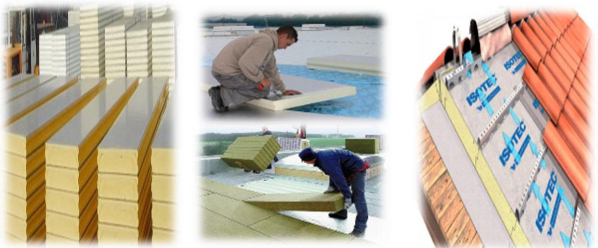
Figura 2. Procesos de instalación láminas de PUR en viviendas y hogares. Imágenes tomadas de Archiexpo, Aislaconpoliuretano y Etelta
