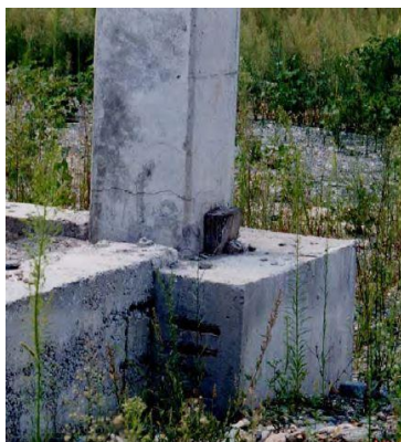
Figura 19. Afectación de columnas prefabricadas por el sismo de Kocaeli (1999) en un sistema de conexión tipo candelabro. Obtenida de (FIB, 2003)
