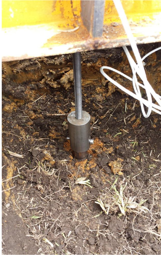
Figura 30. Pila instalada. Elaboración propia
