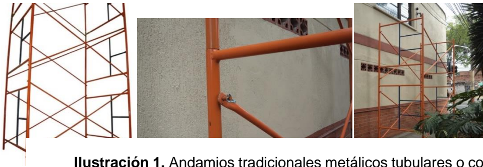
Ilustración 1. Andamios tradicionales metálicos tubulares o con cruceta
