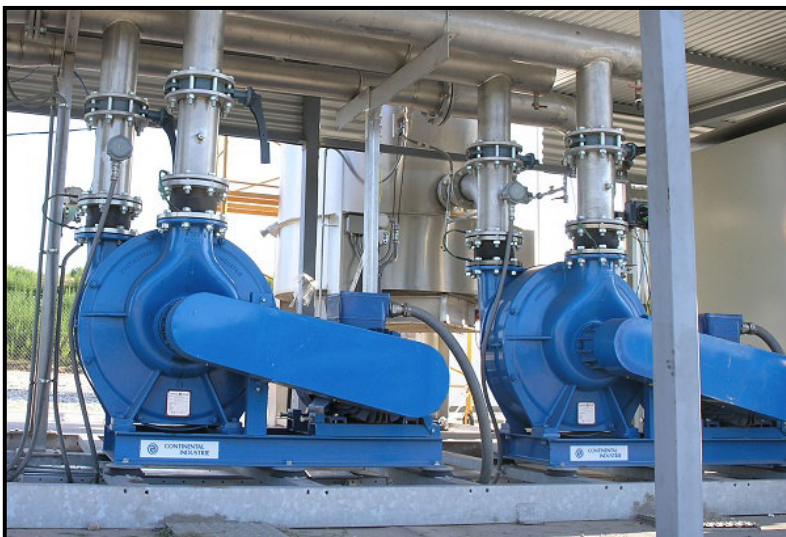
Fig. 3: Aspiradores de biogás
