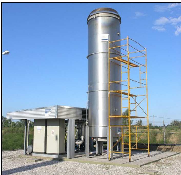
Fig. 6: Planta de aspiración y quemado de biogás
