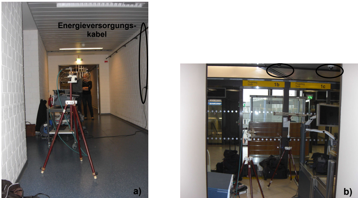
Abbildung 1 Kritische Systeme: a) Bereich vor dem Serverraum und b) Überwachungskameras
