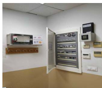
Figura 6. Sistemas de control.
