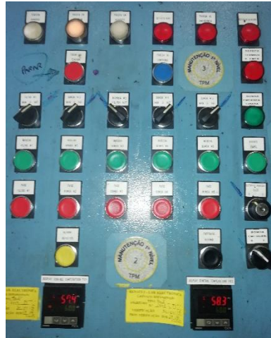
Figura 44- Quadro elétrico com necessidade de mudança da etiquetagem
