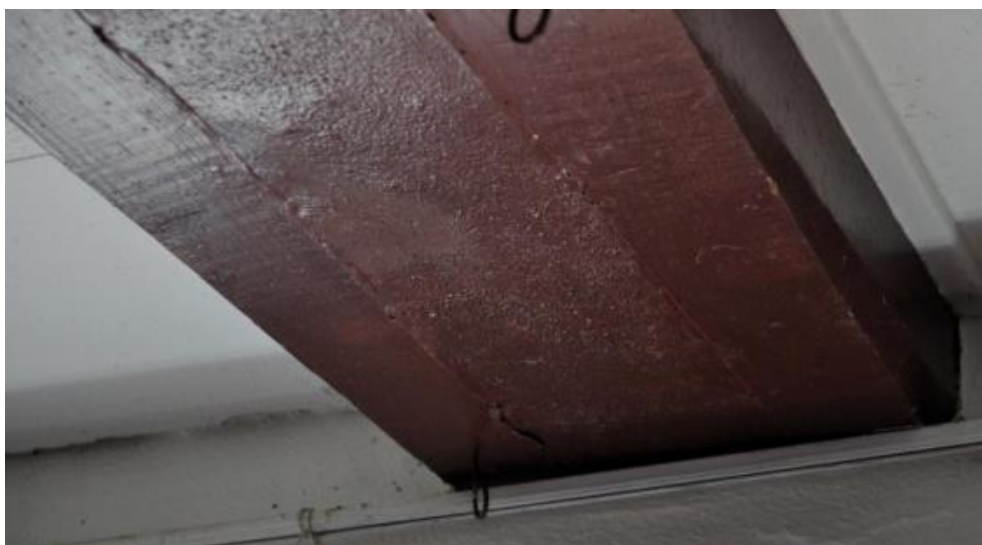
Figura 48 - Reforço de betão envolvido por duas vigas de madeira no local da parede removida (InovaDomus Anomalias, 2003)
