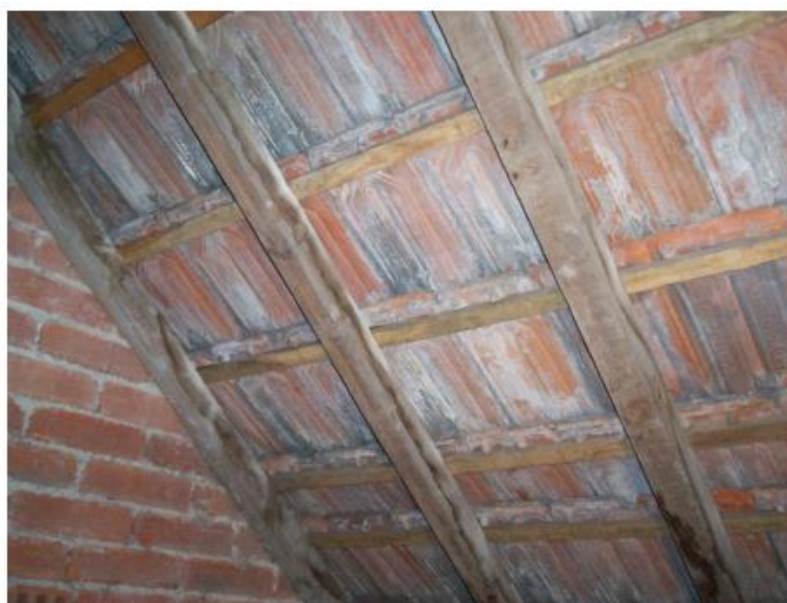
Figura 35 - Ripas da cobertura (InovaDomus Anomalias)
