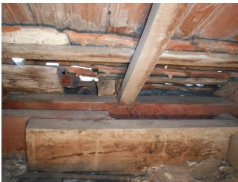
Figura 38 - Deficiente colocação de telhas cerâmicas (InovaDomus Anomalias, 2003)
