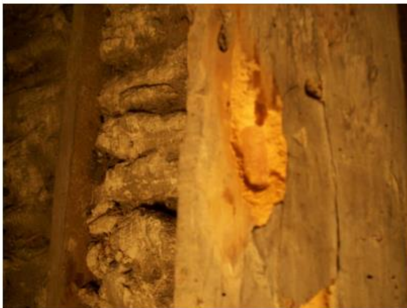
Figura 39 - Diminuição da secção de vigas (InovaDomus Anomalias, 2003)
