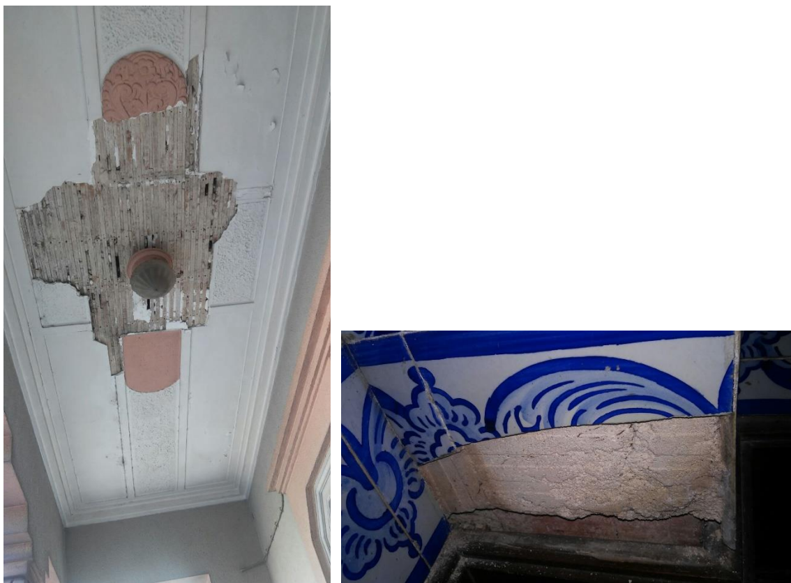
Figura 59 - Exemplo das zonas de empolamento/destacamento
