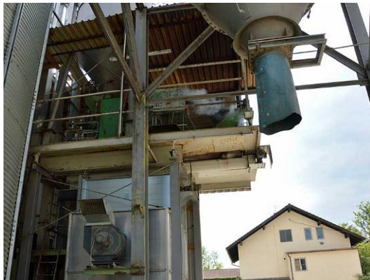
Aufbereitungsanlage Stadlhuber © FiBL Deutschland, Ludwig Asam
