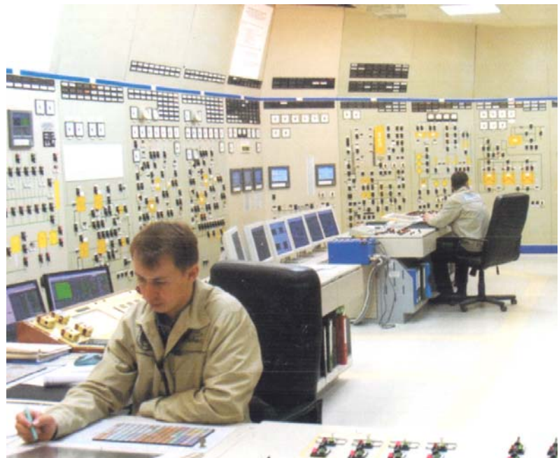
Блочный щит управления блока № 4 Ровенской АЭС
