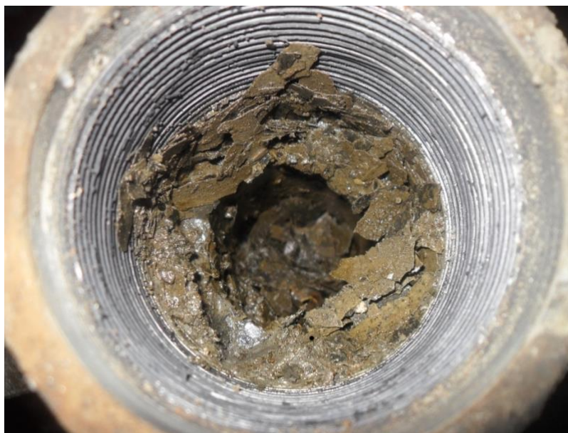
Рисунок 1 – Солеобразование в насосно-компрессорных трубах
