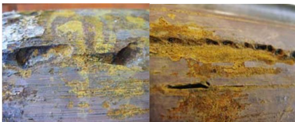
Рисунок 2 – Внешний вид деталей, поражённых язвенной (питтинговой) коррозией и мейза-коррозией
