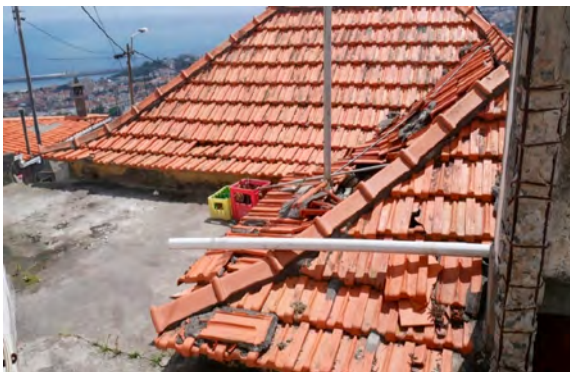
Figura 1. Erros de conceção/execução
