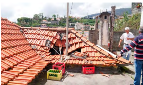
Figura 2. Práticas de manutenção inadequadas
