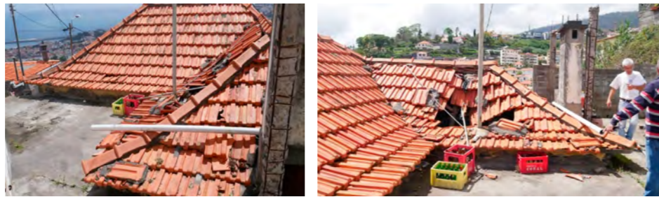
Figura 1. Erros de conceção/execução Figura 2. Práticas de manutenção inadequadas
