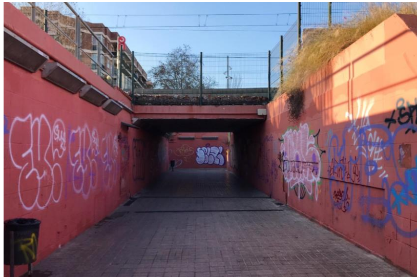
Ilustración 75. Estado actual del paso subterráneo de la Av. de la Platja. Fuente: Elaboración propia.
