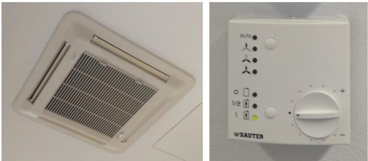
Figura 22 Fancoil i termòstat
