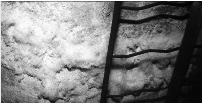
Figuur 6 - Afbeelding van de keldermuur bedekt met schimmel.
