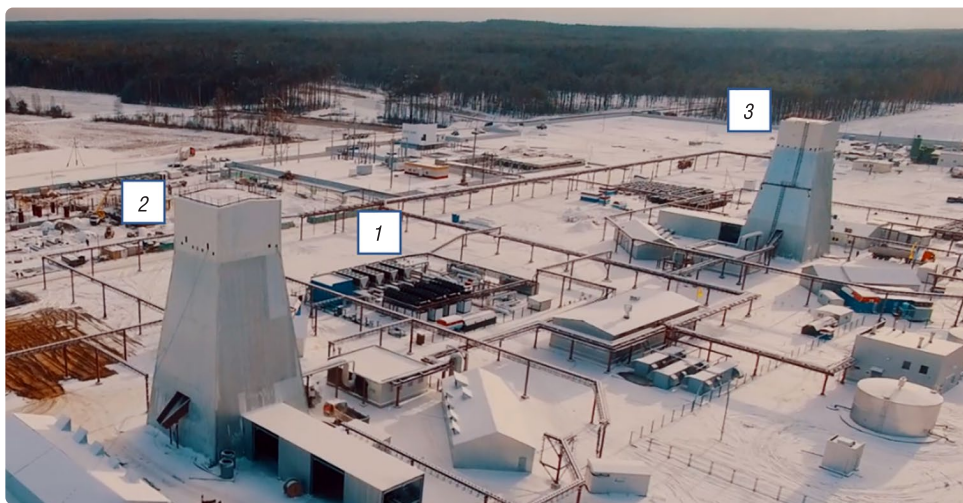
Рис. 3. Размещение шахтных стволов и замораживающего оборудования на промплощадке Петриковского ГОКа (конец 2016 г.): 1 – замораживающая станция, 2 – проходческий копр скипового ствола, 3 – проходческий копр клетьевого ствола
