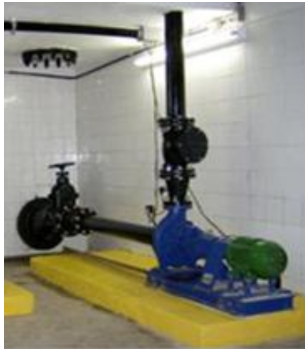
Figura 2 - Conjunto motor bomba com detalhe da interligação
