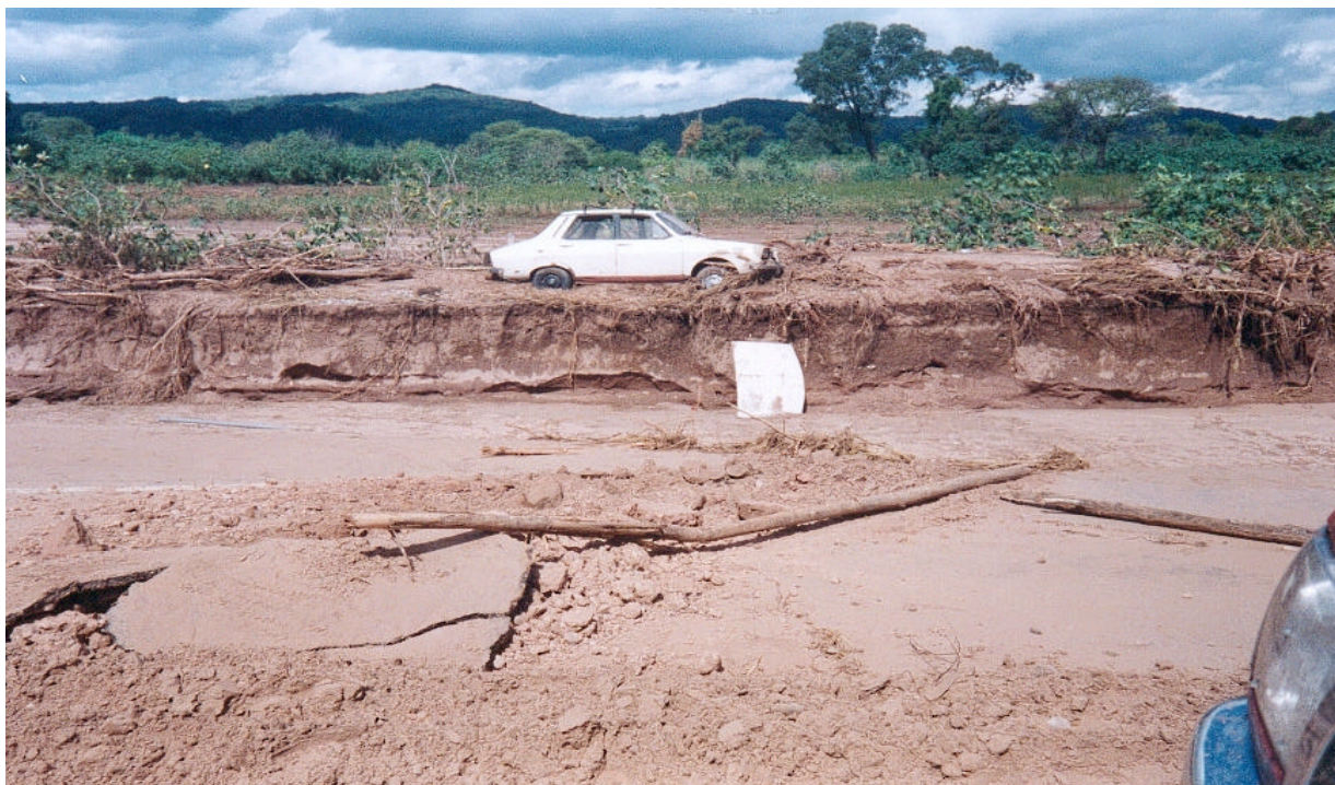
Foto 40 - Destrucción parcial de la ruta provincial n a 81 y enlames marginales en cultivos adyacentes. Se observa un vehículo que fuera movilizado y soterrado en parte.
