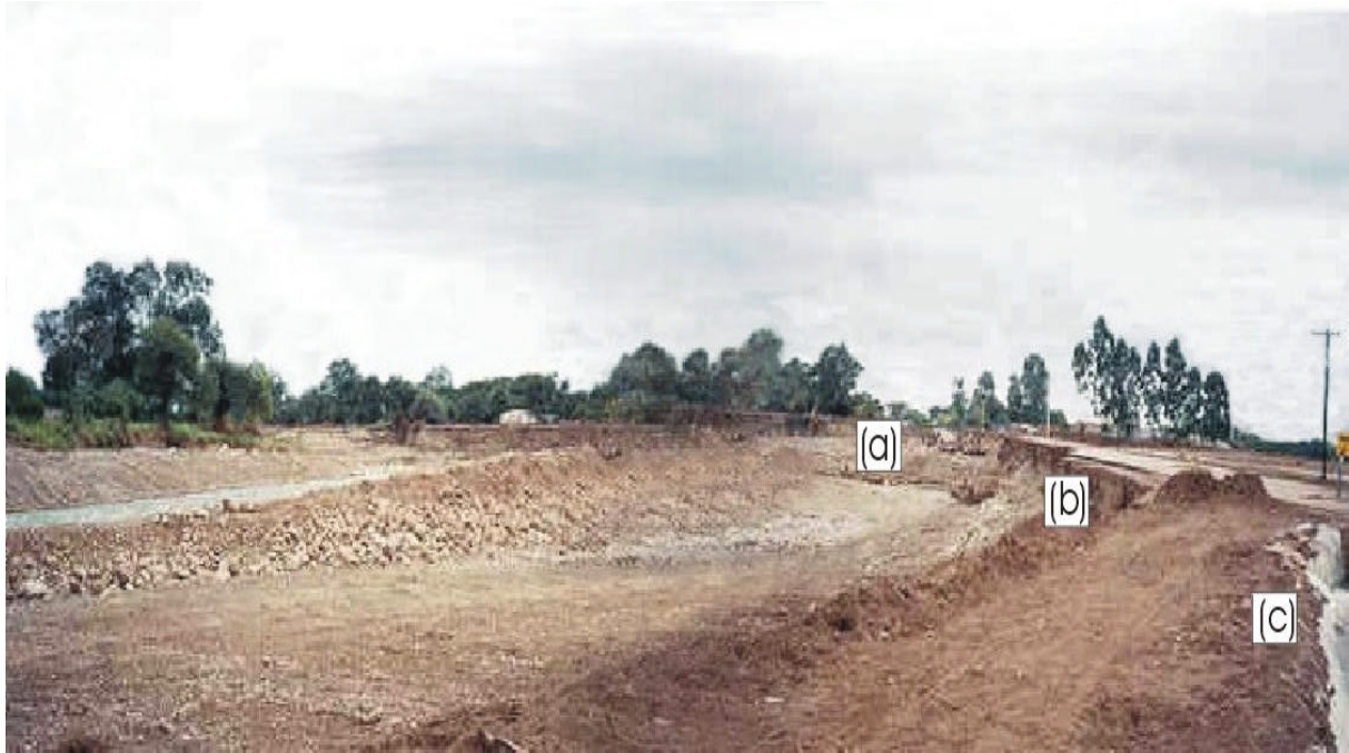
Foto 33 - Las "patas de gallo" (a) señalan la boca del ingreso del "ramal" del aluvión a Puesto Nuevo. A la derecha se observan daños (b) en la ruta provincial n° 6 (descalce) y en el ángulo inferior derecho la reparación de una parte del canal de riego de Puesto Nuevo(c). También se comprueba su peligrosa cercanía a la pendiente externa de la sinuosidad del arroyo Santa Rita.
