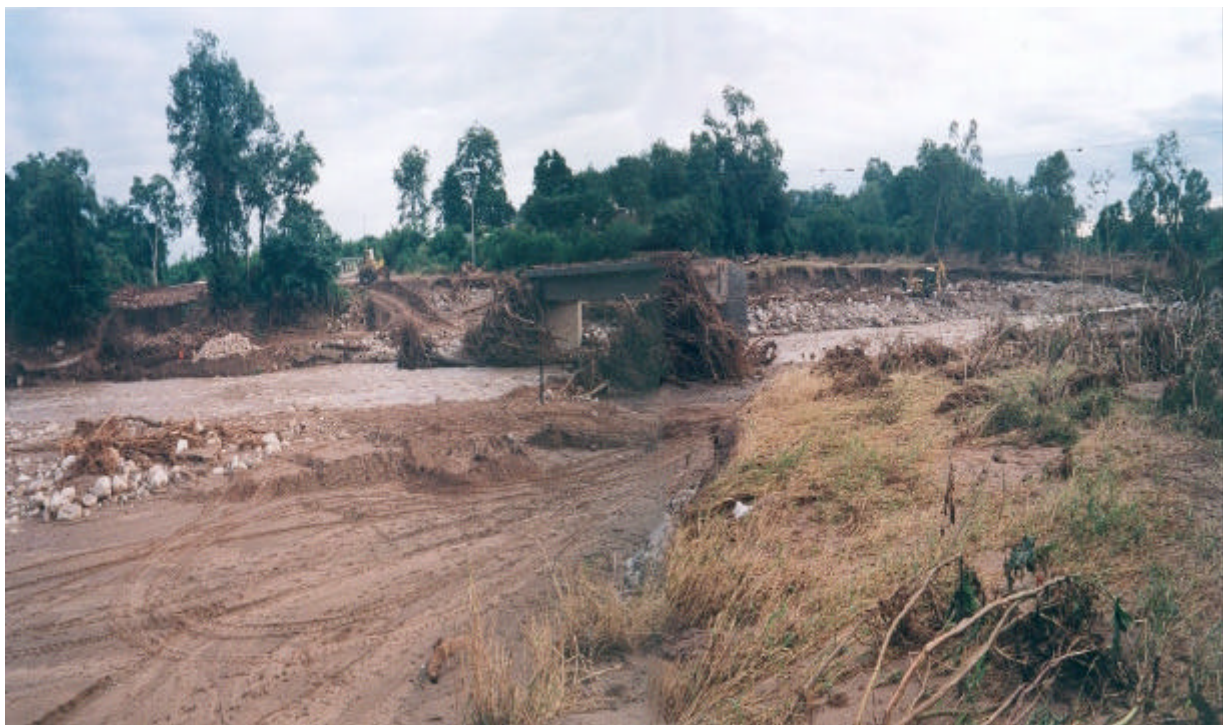
Foto 22 - Vista del puente de Palma Sola luego del colapso de sus terraplenes y la generación del circunstancial aluvión no natural. Su estructura no sufrió mayores daños. Se ven restos de la vegetación que obstruyó el paso de la creciente por su sección inferior.
