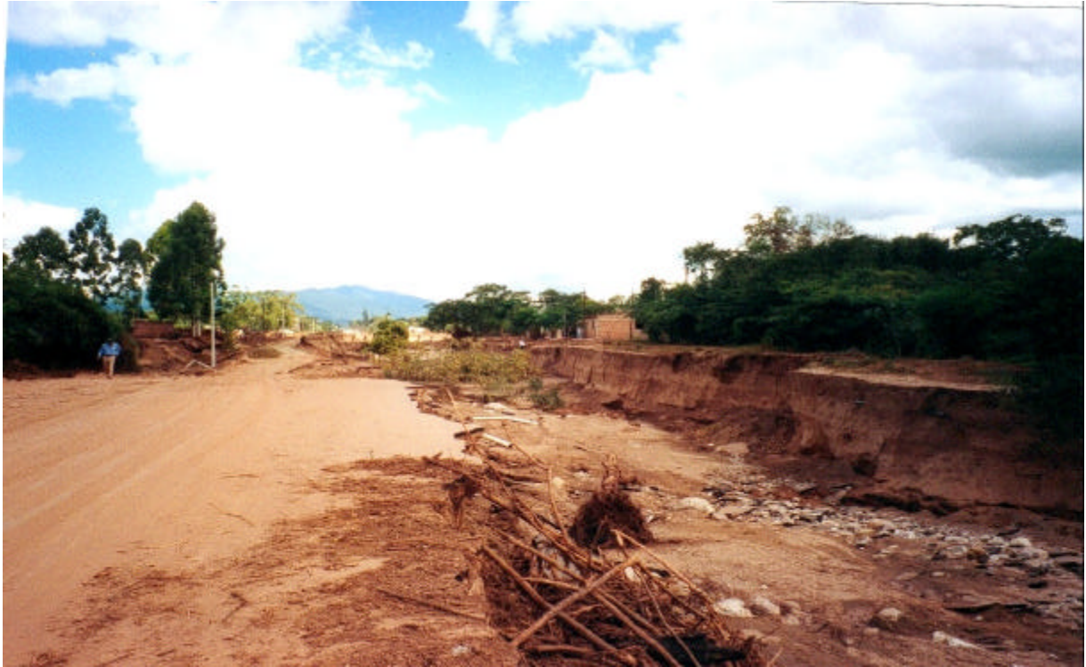
Foto 35 – Otra vista de la cárcava, que muestra sus altas escarpas de erosión y los daños en la ruta provincial n a 6.
