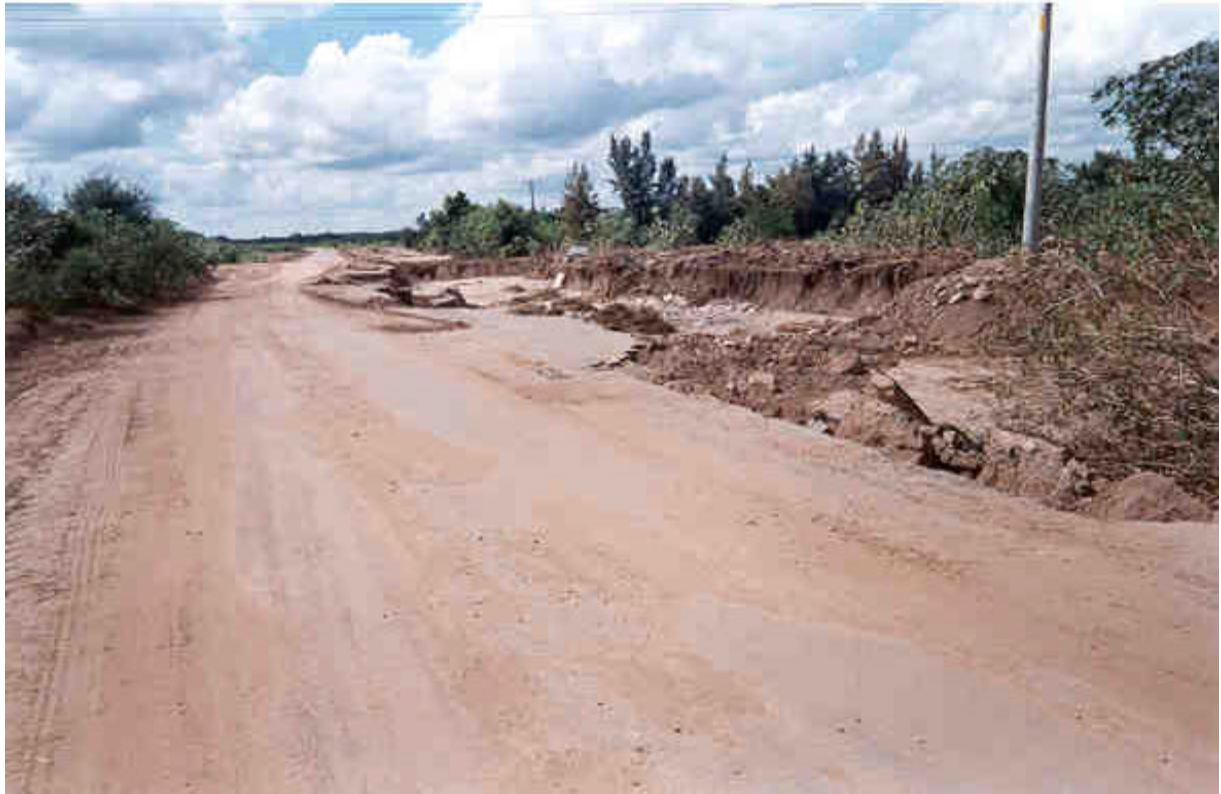
Foto 39 - Daños producidos por la “cabeza” del “ramal” principal del aluvión a lo largo de la ruta provincial n a 81, en un tramo situado inmediatamente al norte de Puesto Nuevo.
