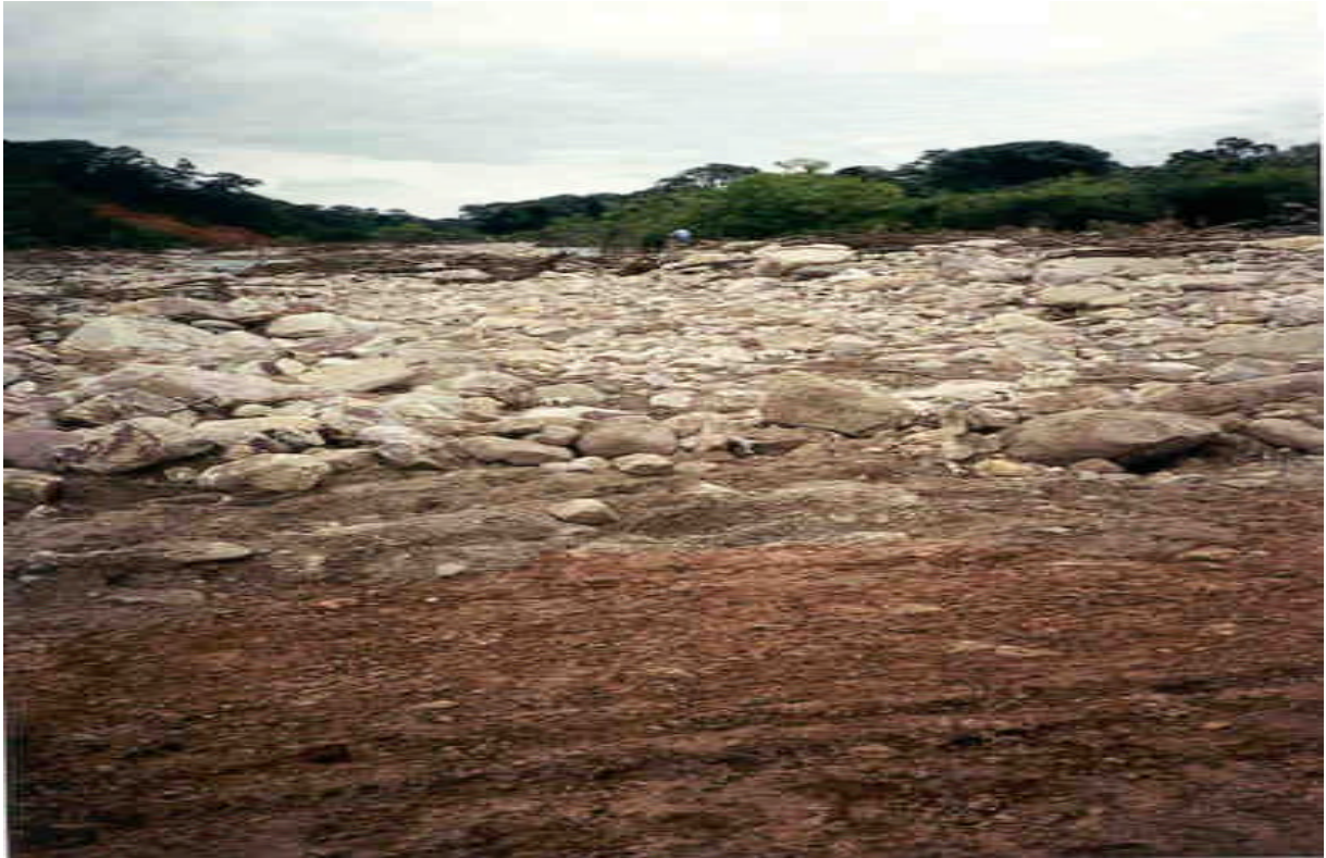
Foto 25 - Hoy en su reemplazo, un precario badén (primer plano) permite su cruce. Al fondo, la persona está encaramada sobre los restos del puente desplazado unos 150 metros aguas abajo de su primaria localización
