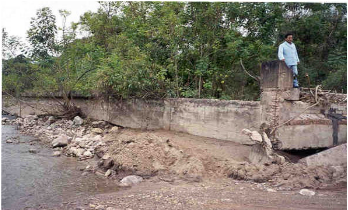
Foto 24 – Vista del puente de la ruta provincial n o 6 construído sobre el arroyo Santa Rita al sur de El Típal y que fuera desplazado por la creciente del año 1984.
