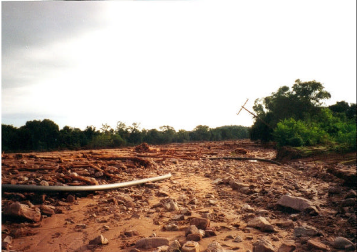
Foto 15 - Restos de la cañería (acueducto) entre la "toma" de El Tipal y la planta potabilizadora de Isla Chica. También se observan daños en la red eléctrica.
