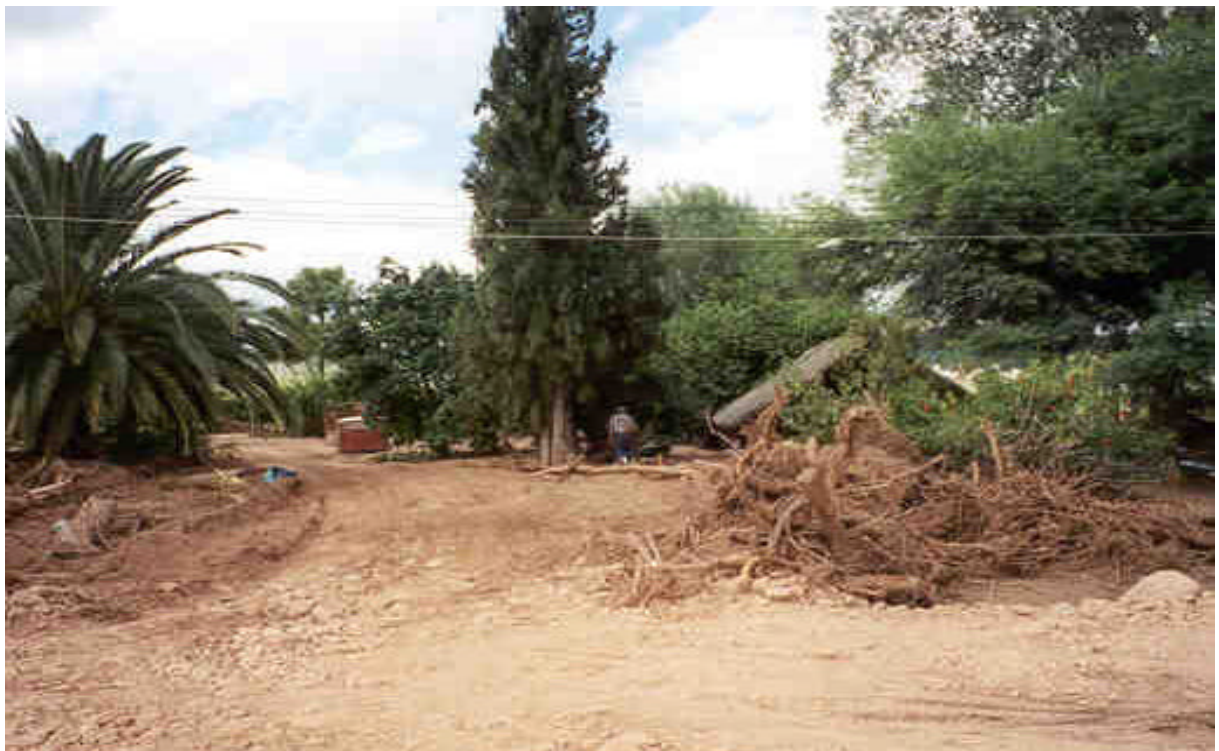
Foto 38 - Trabajos de recuperación en viviendas y caminos urbanos de la población de Puesto Nuevo.
