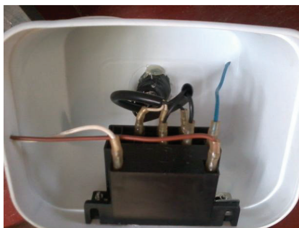
Figura 3: Fotografia do interior do equipamento LOT-G3, mostrando os terminais de ligação e o transformador (usina fogão 4 bocas), a base da lâmpada incandescente fixada em um pote de sorvete 2 litros.
