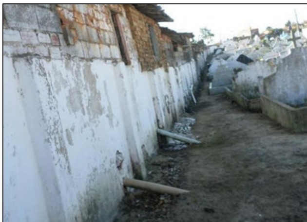
Figura 5 – Encanação do Sistema de Esgoto Fonte: Arquivo pessoal dos autores LATITUDE: 8° 58' 36, 18" S – LONGITUDE: 35° 55' 52, 26" W, 2016
