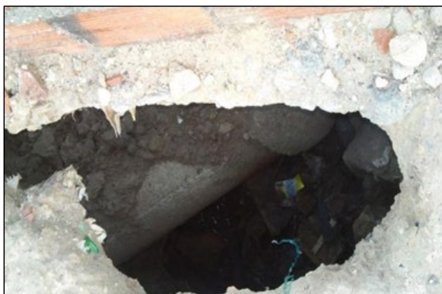
Figura 6 – Rede de Esgoto Estourada Fonte: Arquivo pessoal dos autores LATITUDE: 8° 58' 34, 34" S – LONGITUDE: 35° 55' 50, 77" W, 2016
