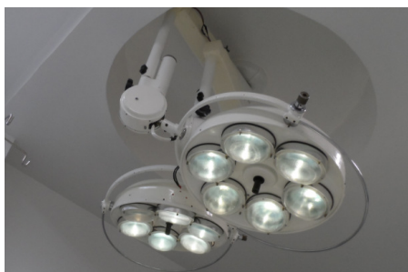
FIGURA 11 - Sistema de iluminação de tarefa da sala de cirurgia 5 - hospital B FONTE: arquivo próprio
