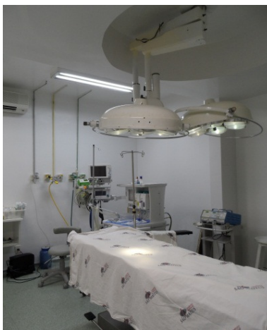
FIGURA 09 - Sala de cirurgia 5 - Hospital B
