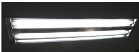
FIGURA 10 - Luminária do sistema de iluminação geral da sala de cirurgia 5 - Hospital B FONTE: arquivo próprio
