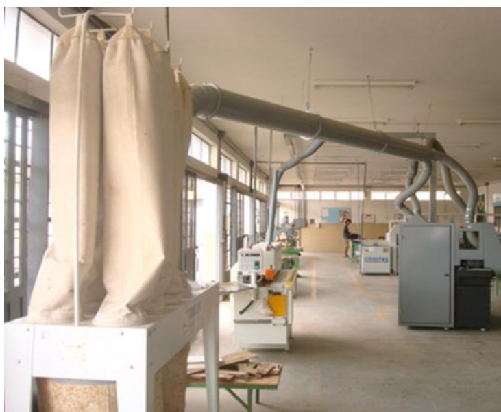
Figura 1 – Sistema de exaustão acoplado a plaina moduladeira de quatro faces utilizada no corte de aparas do bambu. Fonte: Autor (2012).
