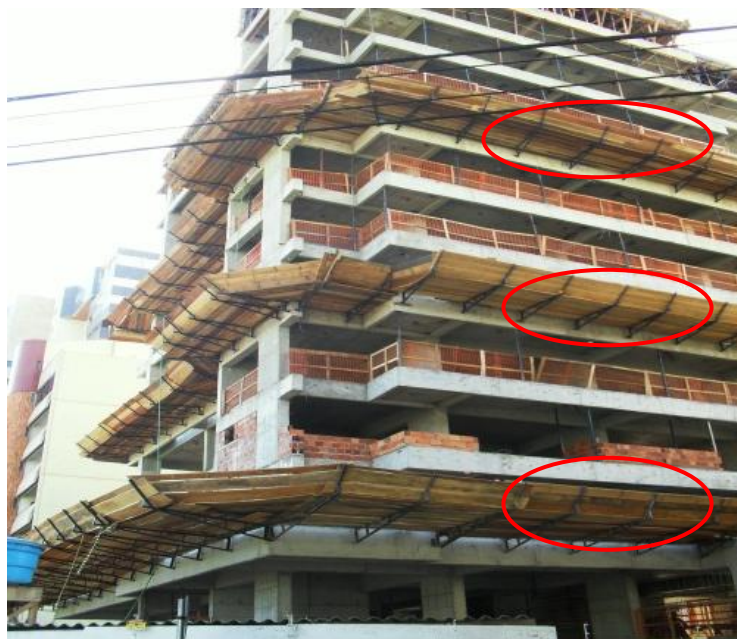
Figura 4 – Em destaque vermelho, bandeijões utilizados como Equipamento de Proteção Coletiva (EPC) em obra. Fonte: Autor (2012).
