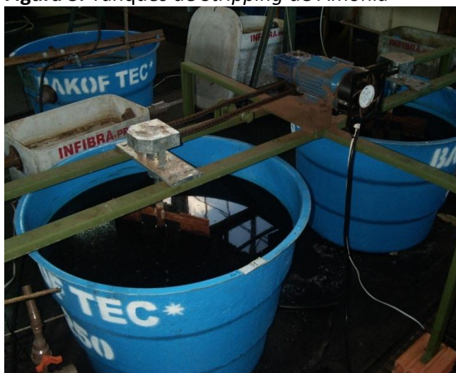
Figura 3. Tanques de Stripping de Amônia
