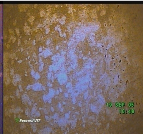
Gambar 4. Korosi sumuran pada badan bejana reaktor RSG-GAS [10]
