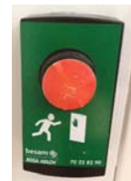
(写真7)非常ボタン
