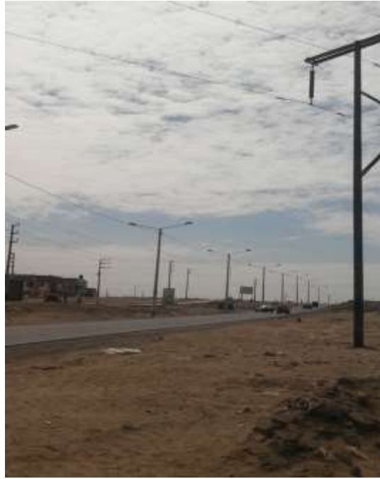
Redes de Distribución en Media y Baja Tensión cerca a la LT-1112.
