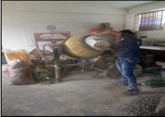
FIGURA N° 51: Luego de mezclar agregamos agua y cemento según la dosificación, y mezclamos.
