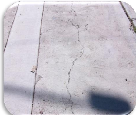
Figura N°: 23 Medición grieta longitudinal 5 - 10mm (Av. Central) - 35 años de vida útil – suelo: arena grava Fuente: Elaboración propia
