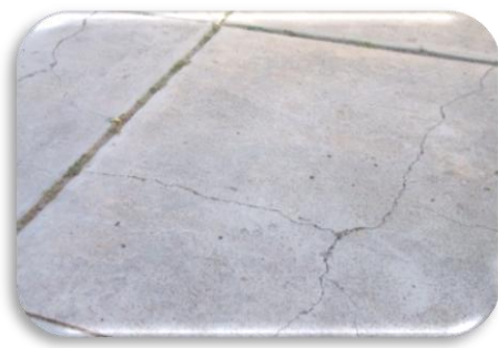
Figura N° 22: Medición grieta transversal y diagonal 13- 9mm (Jr. Amancaes) - 25 años de vida útil – suelo: arena y grava.
