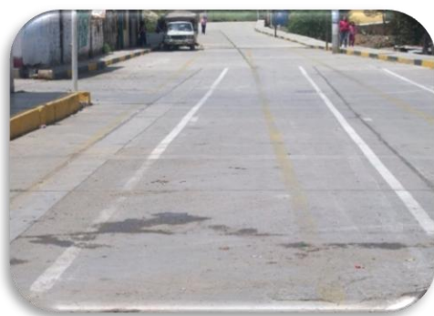
Figura N° 25: Medición grieta de losas divididas > 10 paños divididos (Jr. Las Palmas) > 20 años de vida útil – suelo: arena arcillosa
