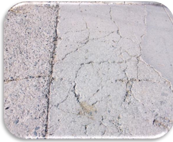
Figura N°13: Fisuramiento por retracción
