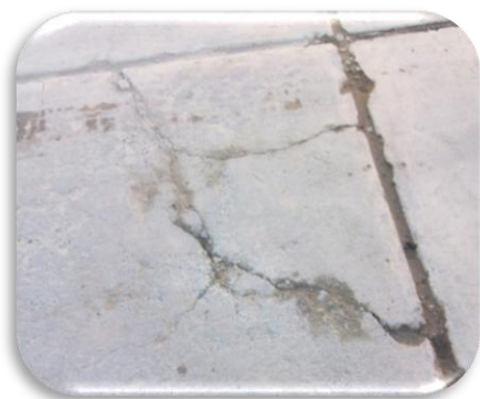
Figura N°24: Medición grieta de esquina > 15mm (Jr. Av. Central intersección de Víctor Véllez) > 35años de vida útil – suelo: arena y grava
