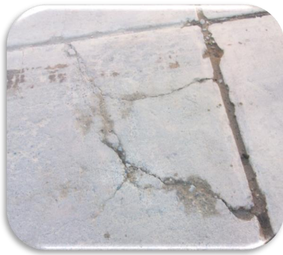
Figura N° 09: Grietas de Esquina
