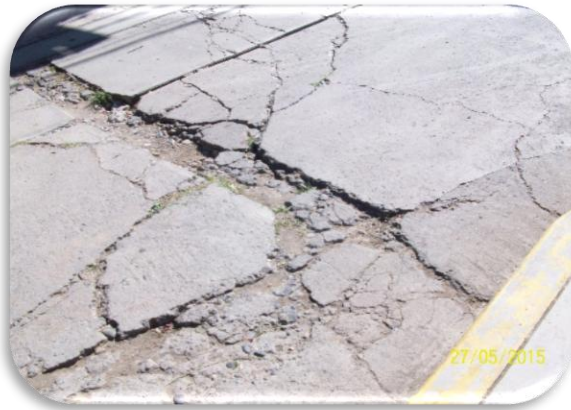
Figura N° 17: Escalonamiento de juntas y grietas
