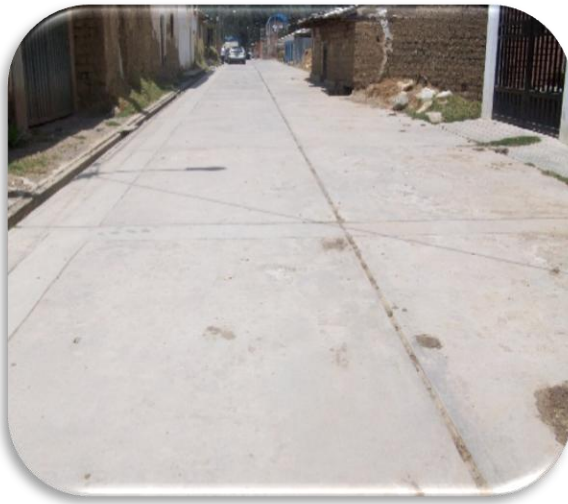
Figura N° 19: Separación entre berma y pavimento
