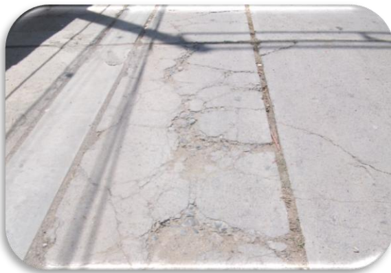
Figura N° 06: Deficiencias del sellado de juntas
