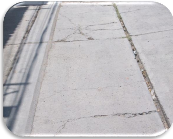
Figura N° 08: separación de la junta longitudinal
