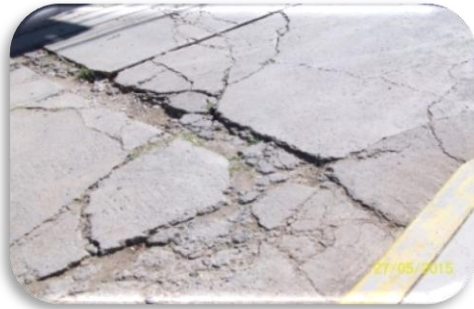
Figura N° 26: Medición de fisuras en bloque > 10 paños divididos (Jr. Amancaes intersección de Jr. Las Palmas) > 25 años de vida útil – suelo: arena arcillosa
