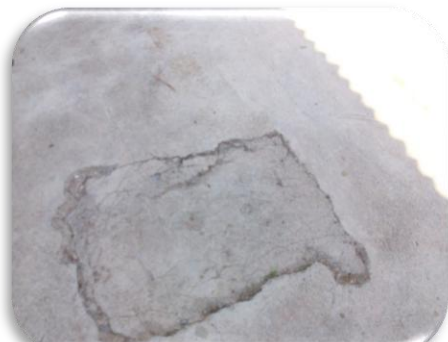
Figura N° 28: Medición de parchados > 10 paños divididos (Jr. Amancaes) > 25 años de vida útil – suelo: arena arcillosa Fuente: Elaboración propia
