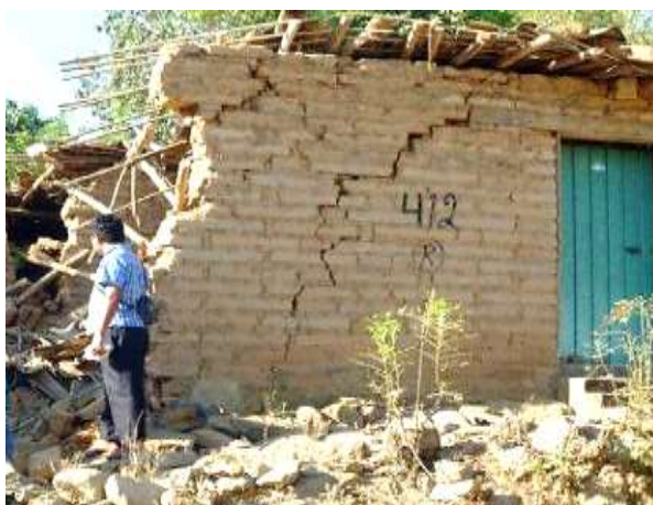
Figura 18: Estado actual de las viviendas en Chua Bajo – Huaraz.
