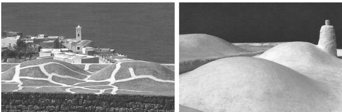
Ilustração 90 – À esquerda: reparação das micro fissurações; à direita: camada completa de cal sobre as cupolas (D'Aietti, 2009).
