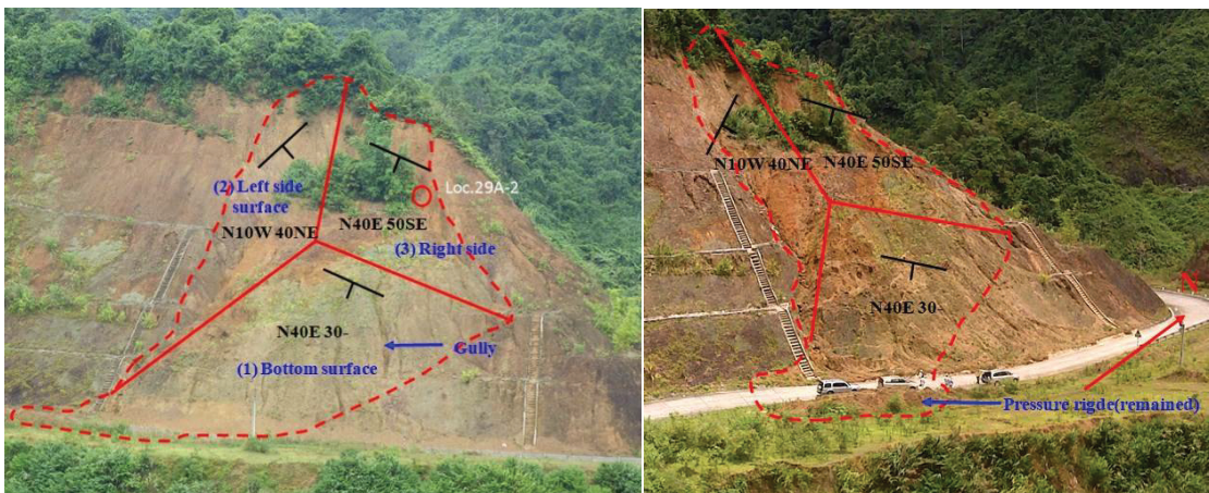
Fig.4. 89 Landslide Loc.29 on Ho Chi Minh route
