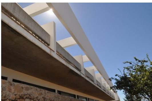
Ilustração 115 – Pormenor do plano suspenso dos quartos da ala nova, da fachada Norte da Pousada do Crato. (Ilustração nossa, 2016).
