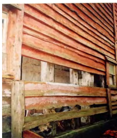
Ilustração 59 - Casa de Madeira: forro exterior das paredes - costaneira trincada. ([Adaptado a partir de:] Vaz, 2010, p. 50)
