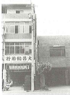
写真-20 隙間の両側の住宅 (台中市)
