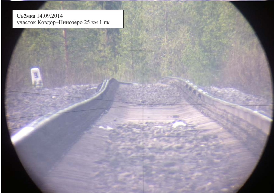
Рис. 6. Относительные просадки пути на 25-м км участка Ковдор–Пинозеро.
