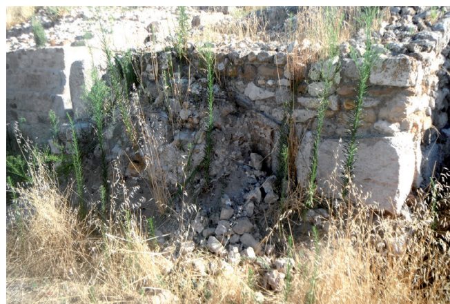
Figura 13. Vista de la torre oriental (número 6), antes de la intervención, donde se puede apreciar el derrumbe, adosado a un sillar y a la propia fachada de la torre y consolidado como refuerzo en intervenciones anteriores
