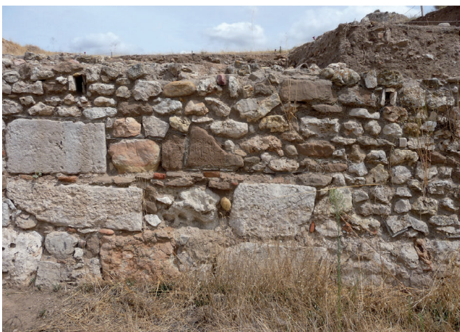
Figura 19. Intervención realizada en los años 80. Lienzo de muralla donde se aprecia abajo a la izquierda el aparejo original concertado de sillares, mampuesto y ladrillo. Arriba a la derecha, restitución de piedra sin carear, acabada con un pretil y dos mechinales de desagüe que remata la zona superior como “obra acabada”
