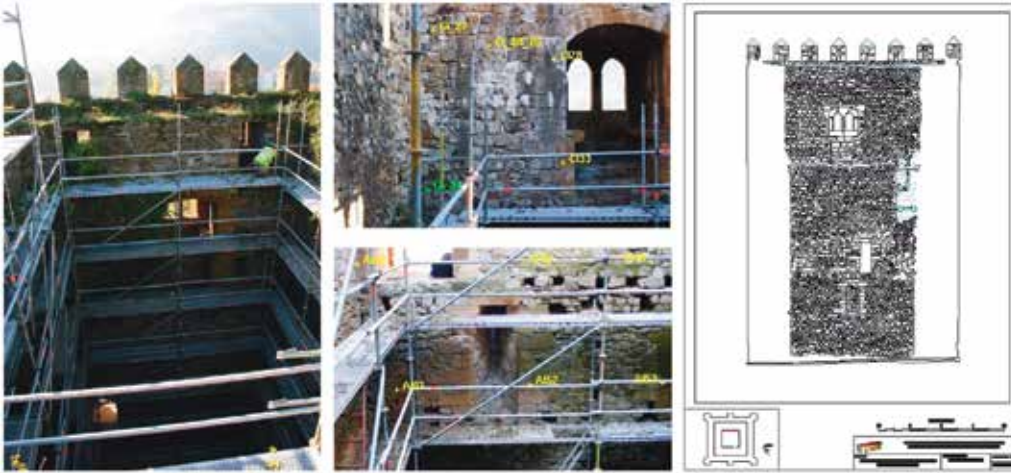
Figura 18.- La imagen de la izquierda corresponde a una vista general del estado del interior de la torre durante el trabajo de documentación. Las dos imágenes centrales son los croquis de dos pares fotogramétricos en los que se aprecia cómo aparecían los andamios (los números corresponden a los puntos de apoyo). A la derecha se presenta el dibujo final, producto de la restitución estereoscópica manual.
