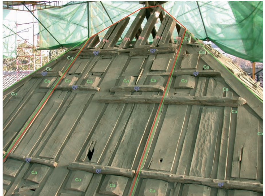
Fig. 3. Techumbre del Cuarto Real de Sto. Domingo. Cada paño se compone de tres paneles prefabricados con maderas diferentes: manguetas y pares torales de pino pinaster y silvestre/laricio (Pn); péndolas, limas y rosetas de cedro (Ca) y refuerzos de quejigo (Qf)
