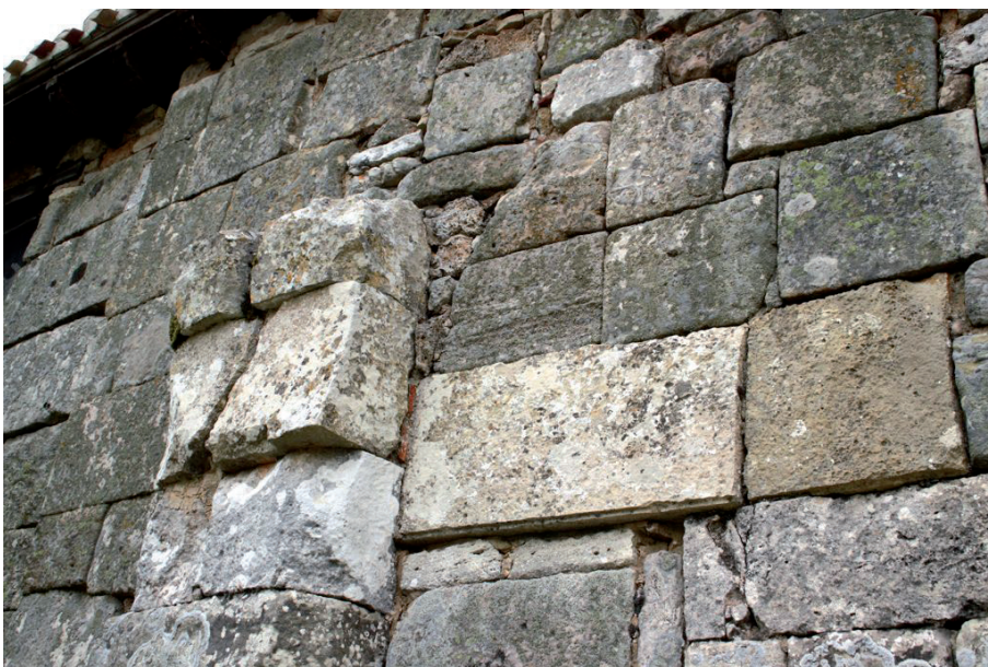
Figura 7.- Quintanilla. Detalle del frente oeste. Arranque de arco, dintel de puerta y arranque de pechina.
